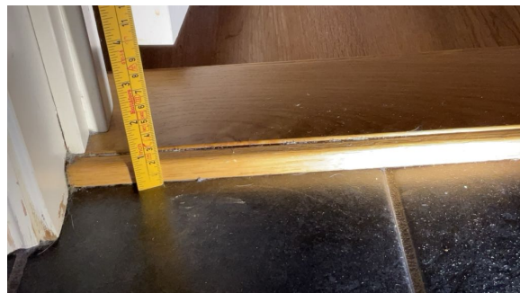
Oppbrett ved terskel målt: 20mm
