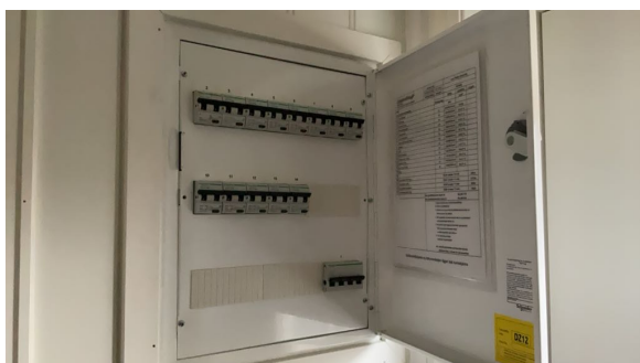
Sikringsskap plassert i entrè.
