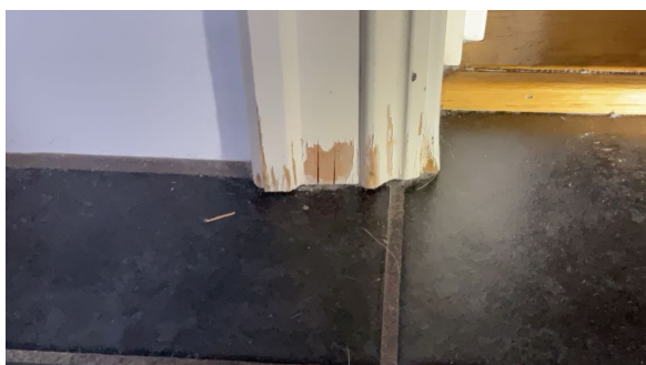
Litt fuktopptrekk i omramning til dør.
