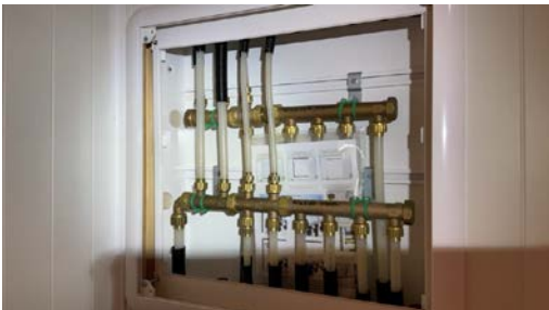
Fordelersskap plassert på bod.
