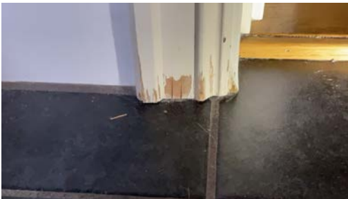
Litt fuktopptrekk i omramning til dør.
