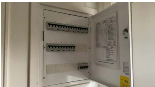
Sikringsskap plassert i entrè.
