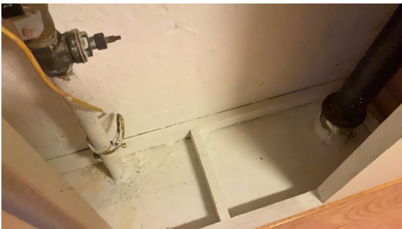
Vann og avløp under betonggulv.
