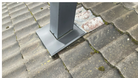
Dårlig løsning på lufting over tak.
