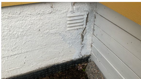
Løs maling på grunnmur.
