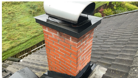
Rust på toppbeslag på pipen
