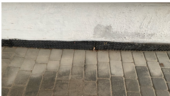
Grunnmursplast ikke tilpasset terreng og uten topplist.
