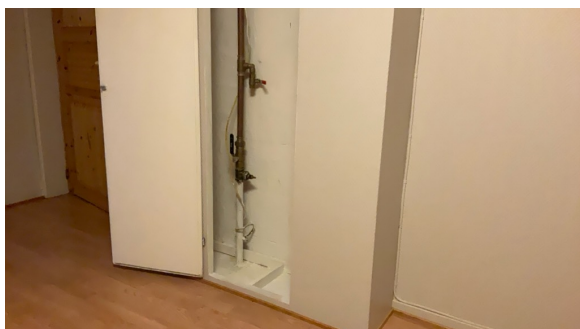
Stoppekran i skap i gang i kjelleren.
