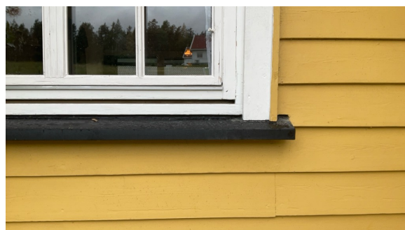
Belistning går helt ned til vannbrett på vinduer.
