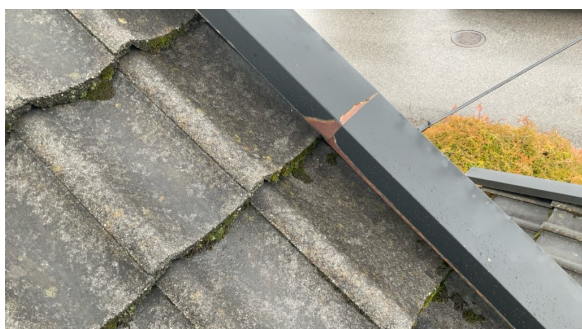
Rust på beslag på vinds kier.
