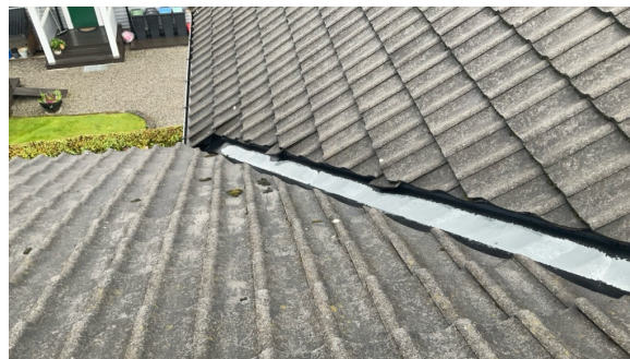
Noen knekte takstein i gradrenne
