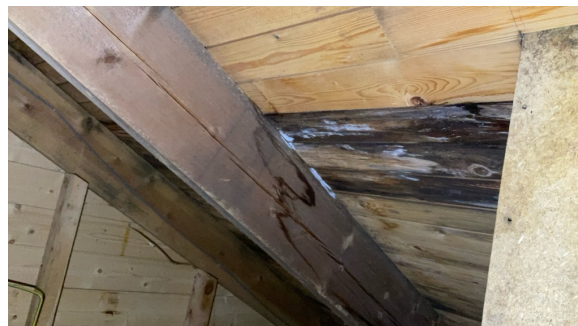
Fukt og muggdannelse etter lekkasje.
