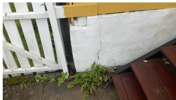
Sprekk i grunnmur.
