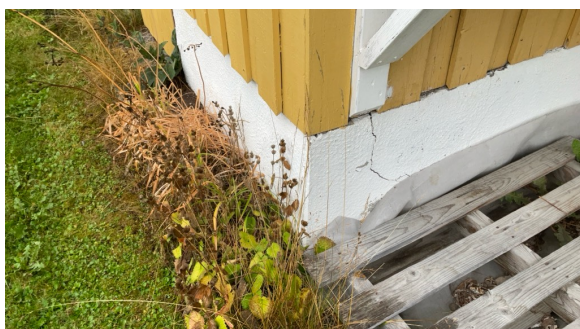
Sprekker i grunnmur
