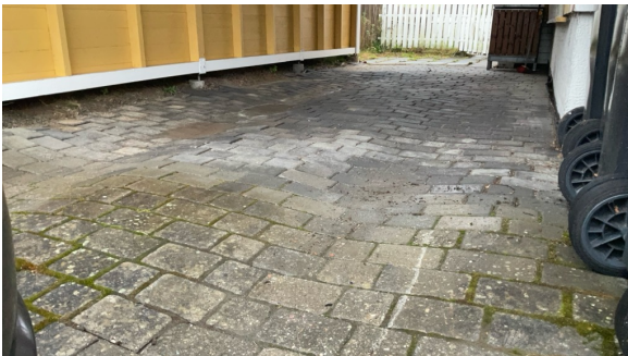
Setninger i masse under belegningsstein
