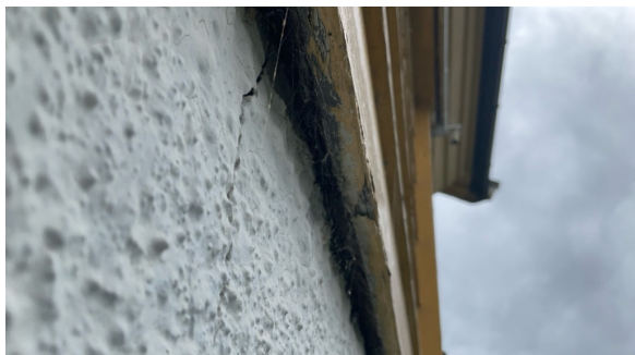
Kledning er montert rett på vindtetting uten luftespalte.
