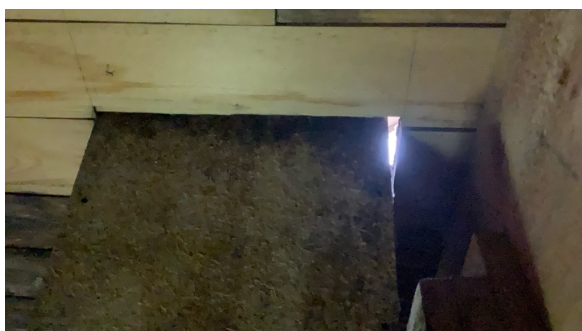
Utett undertak ved pipe.
