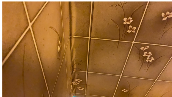
Utette skjøter på våtromstapet.
