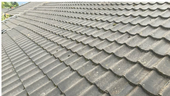
Noe mose og aldersslitasje på takstein.
