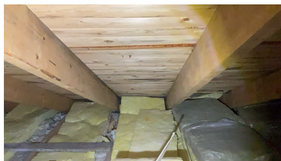
Begrenset/manglende lufting mellom undertak og isolasjon.
