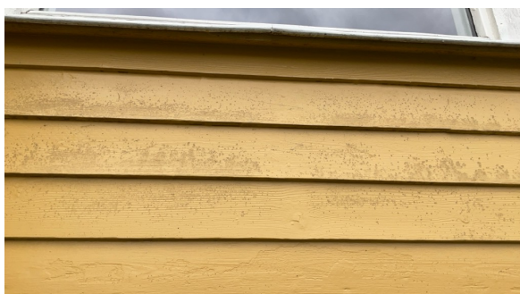
Noe svartsopp på kledning.
