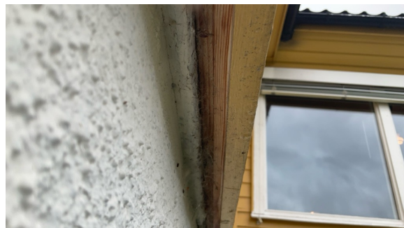
På tilbygg er det ikke lufting i nedre kant.
