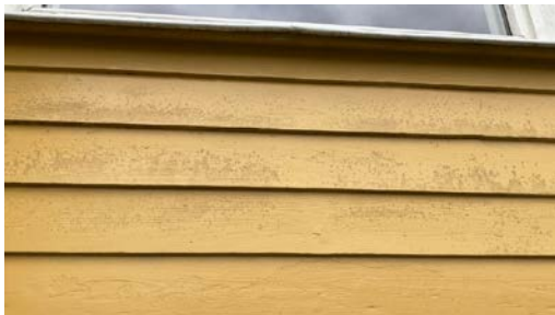
Noe svartsopp på kledning.
