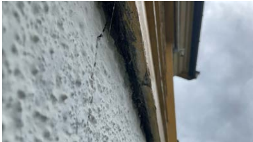
Kledning er montert rett på vindtetting uten luftespalte.
