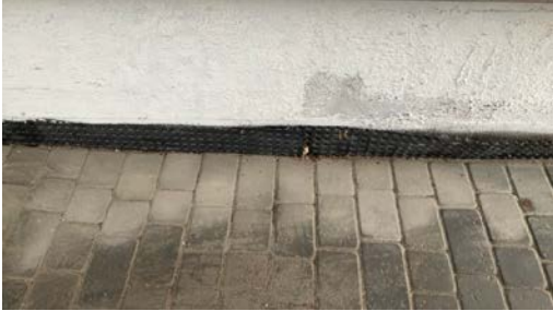
Grunnmursplast ikke tilpasset terreng og uten topplist.
