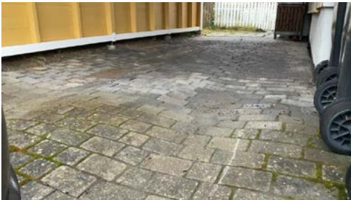
Setninger i masse under belegningsstein
