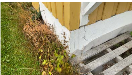
Sprekker i grunnmur
