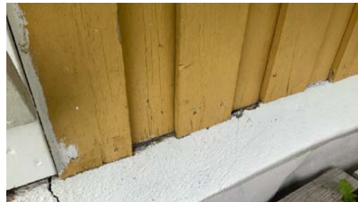
Kledning går stedvis helt ned til grunnmur.
