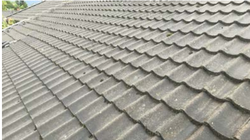
Noe mose og aldersslitasje på takstein.
