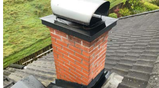
Rust på toppbeslag på pipen
