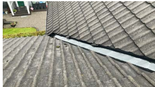
Noen knekte takstein i gradrenne
