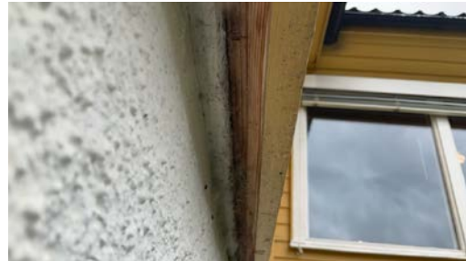
På tilbygg er det ikke lufting i nedre kant.
