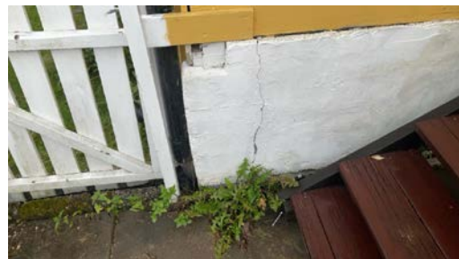
Sprekk i grunnmur.
