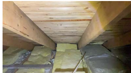
Begrenset/manglende lufting mellom undertak og isolasjon.
