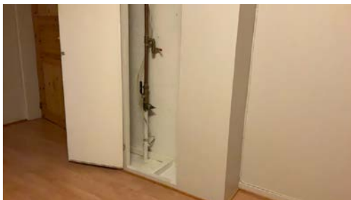
Stoppekran i skap i gang i kjelleren.
