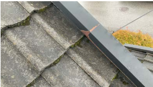
Rust på beslag på vinds kier.
