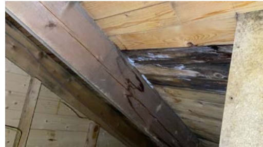
Fukt og muggdannelse etter lekkasje.
