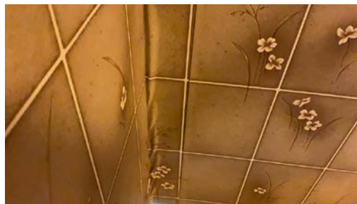
Utette skjøter på våtromstapet.
