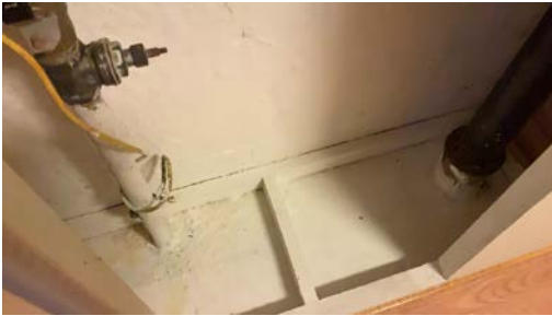
Vann og avløp under betonggulv.
