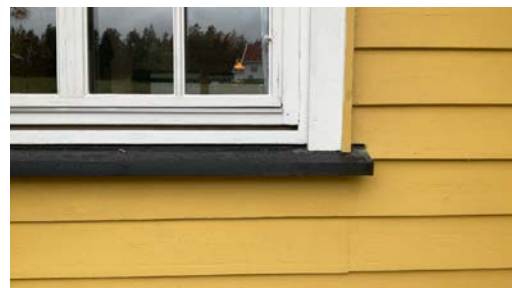
Belistning går helt ned til vannbrett på vinduer.
