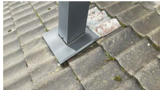
Dårlig løsning på lufting over tak.
