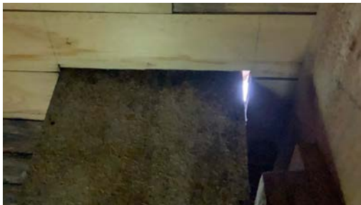
Uttett undertak ved pipe.
