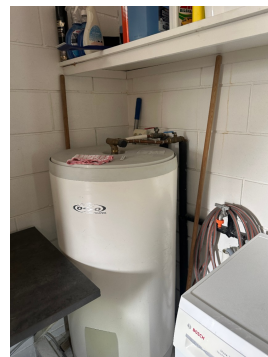
Nyere bereder fra 2009 i kjellerrom
