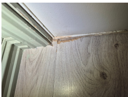
Skade på laminatgulv mot inngangsdør.
