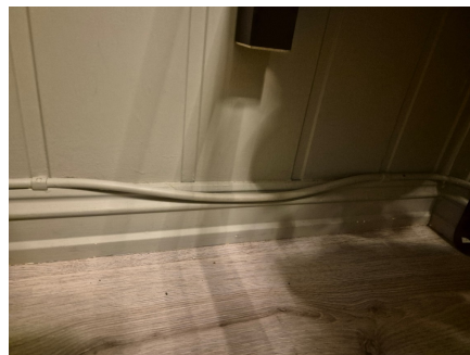
Ledning som ikke er tilstrekkelig festet i gang.
