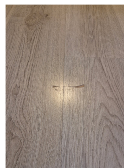
Sår/skade på laminatgulv i gang.
