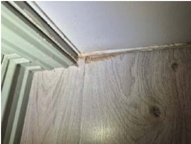
Skade på laminatgulv mot inngangsdør.
