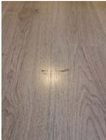
Sår/skade på laminatgulv i gang.
