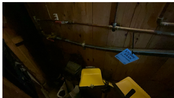
Stoppekrane i kjeller.
