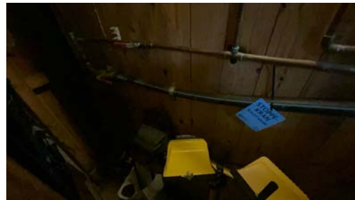
Stoppekran i kjeller.
