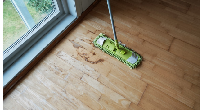
Fuktmerke i parkett.
