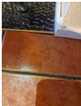
Bildet viser gulvflis med sprekk.
