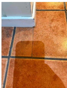
Bildet viser gulvflis med sprekk.
