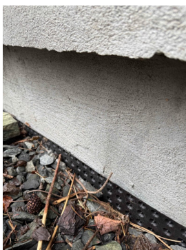
Bildet viser grunnmurplast med manglende toppliste.
