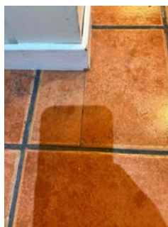
Bildet viser gulvflis med sprekk.
