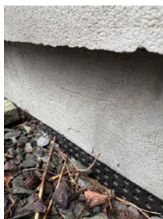
Bildet viser grunnmursplast med manglende toppplast.
