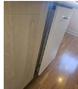
Front på oppvaskmaskin flukter ikke med tilstøtende skapfront.
