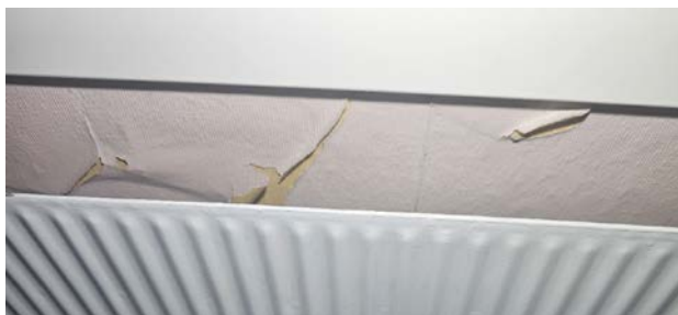
Vegg under vindu på soverom.
