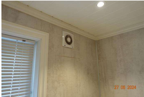
Elektrisk veggmontert vifte.
