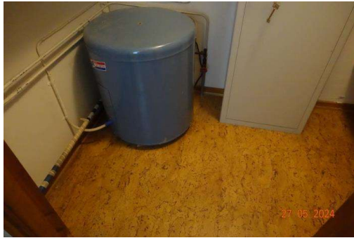
VVS tank i kjeller.
