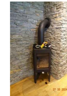
Montert vedfyring i kjellerstue.
