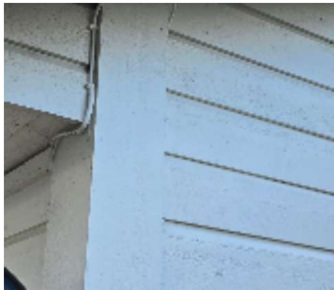
Bilde 2 Kabling til lampe er nok ikke utført av sakkyndige.
