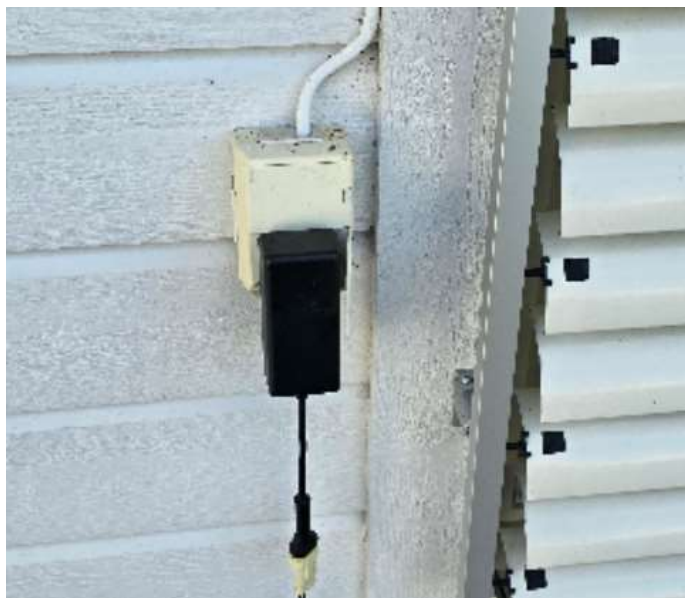
Bilde 3 Stikk ute på veranda er montert feil.
