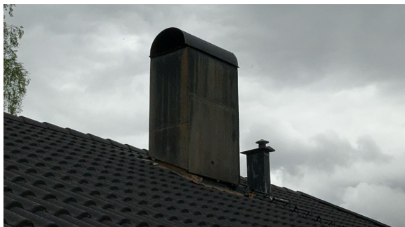
Det rustet på pipebeslag. Modent for utskiftning.
