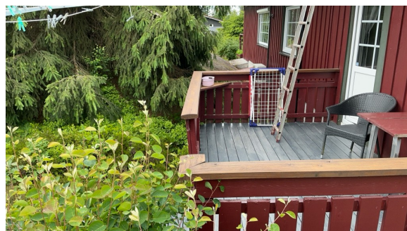
Rekkverk er skjevt.
