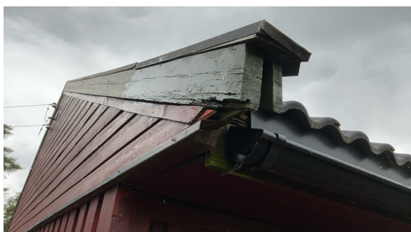
Råteskader i vindski.
