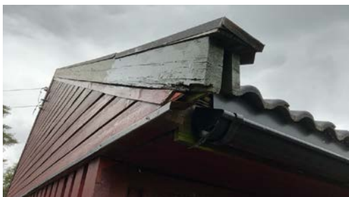
Råteskader i vindski.
