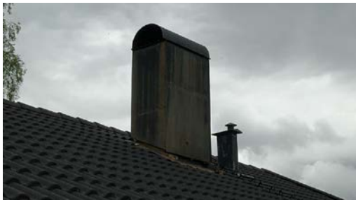
Det rustet på pipebeslag. Modent for utskiftning.
