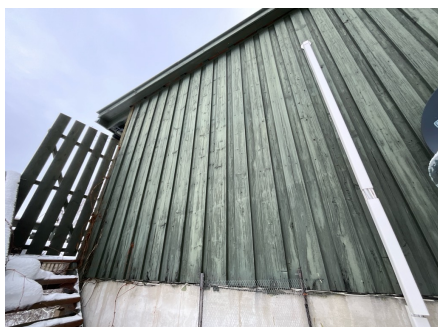
Værslitt kledning på østveggen
