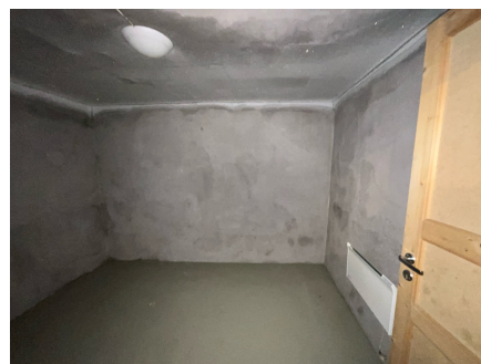
Ising på grunnmur inne i bod under inngangspart
