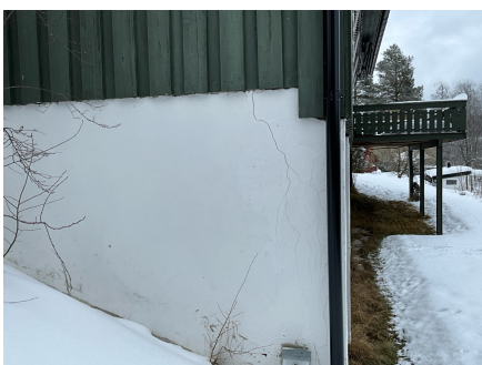
Sprekk i utv grunnmur, vest vegg
