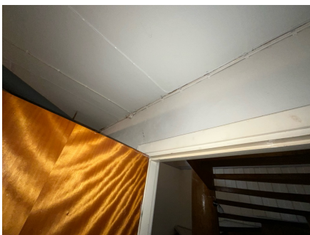
Sprekk i mur over dør mot trapperom.
