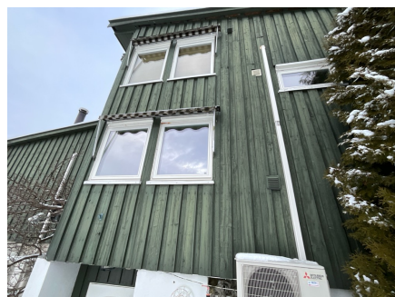
Værslitt kledning på østveggen
