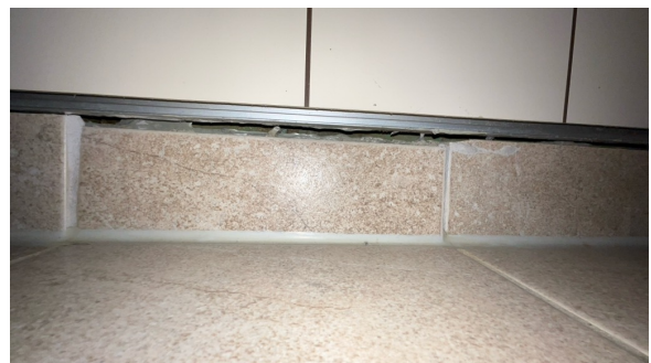
Glippe inn i vegg over sokkelflis
