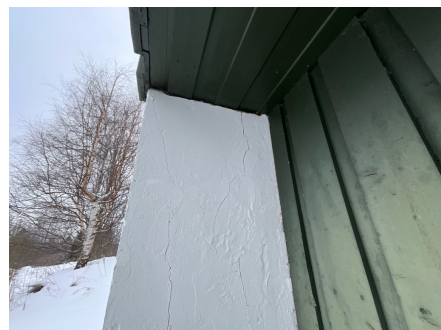
Sprekker i utv grunnmur
