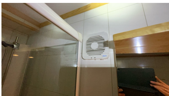
Avtrekk på bad
