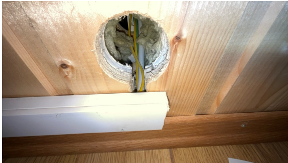
Åpen kabling/boks varmesystem kjellerstue
