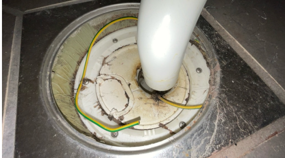
Bilde av sluk
