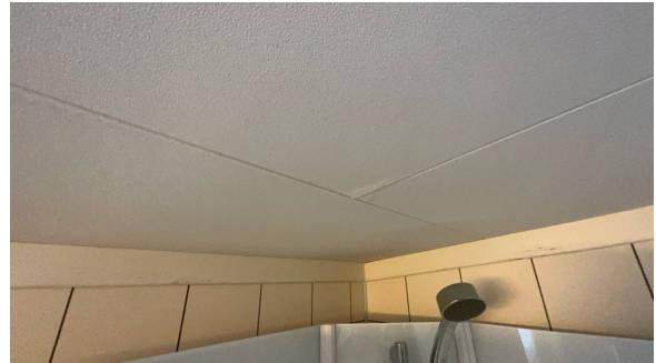
Fuktskade i tak over dusj
