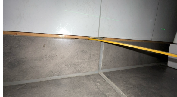
Bilde av åpning under veggplater
