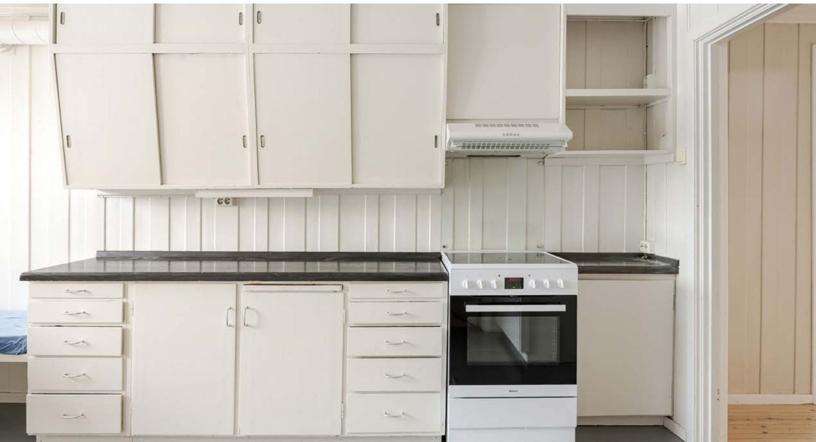
Kjøkkenventilator med avtrekk ut sikrer god luftkvalitet, men lyset i ventilatoren fungerer ikke.
