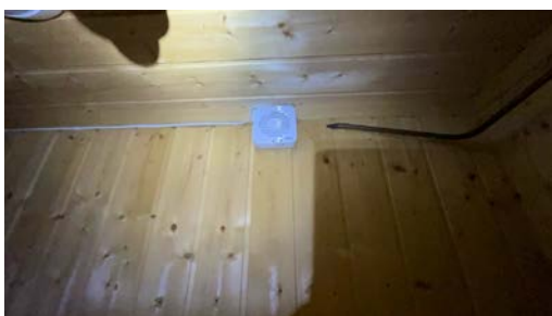
Avtrekk ut fra teknisk rom
