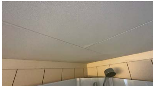
Fuktskade i tak over dusj
