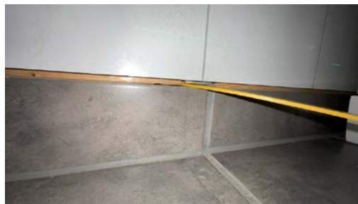
Bilde av åpning under veggplater
