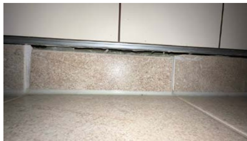
Glippe inn i vegg over sokkelflis
