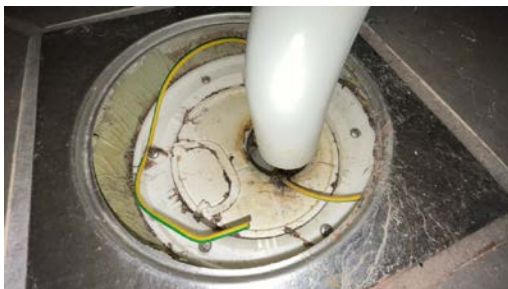
Bilde av sluk
