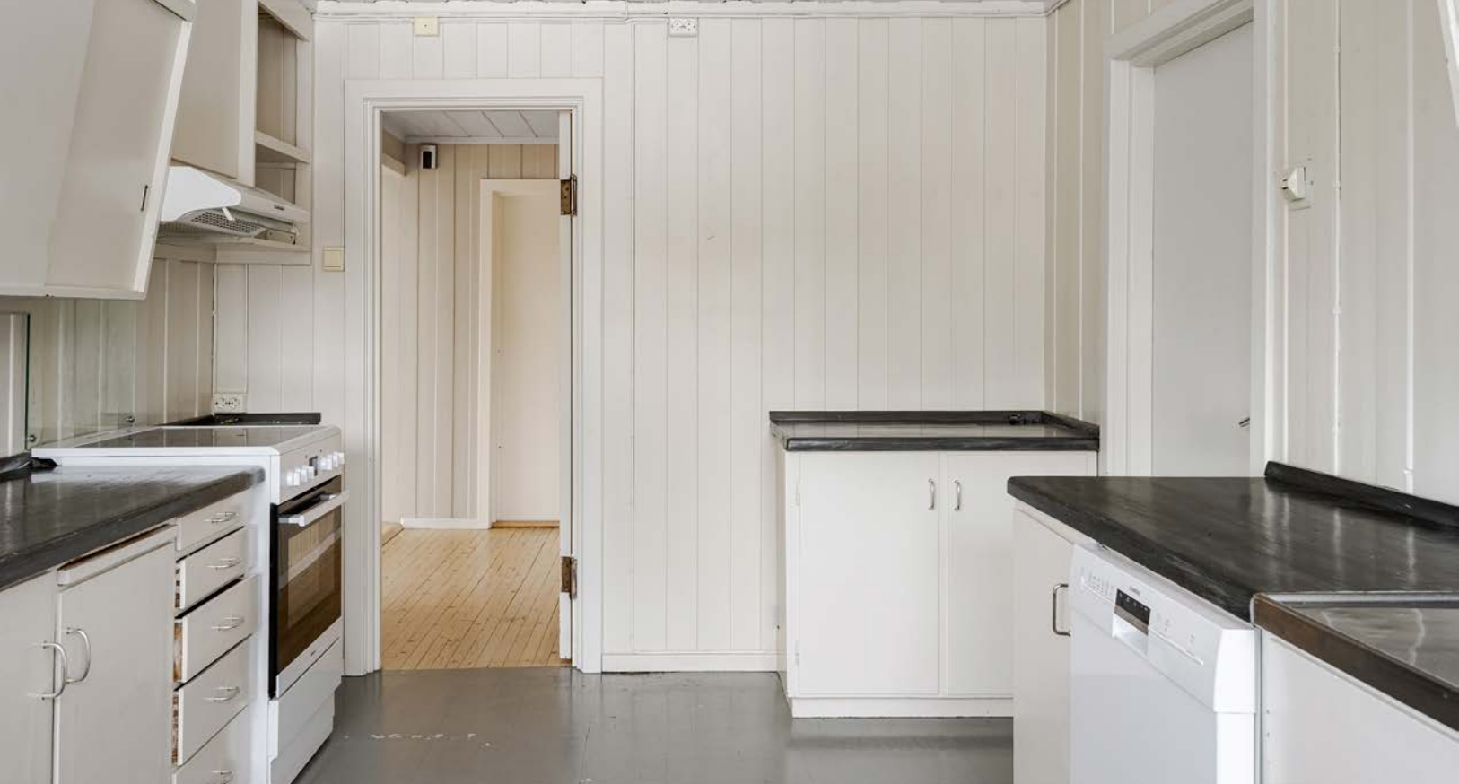
Kjøkkenet har eldre innredning med synlig slitasje på malte overflater og treghet i skuffer.
