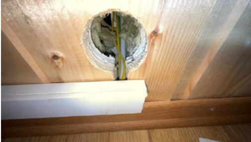
Åpen kabling/boks varmesystem kjellerstue
