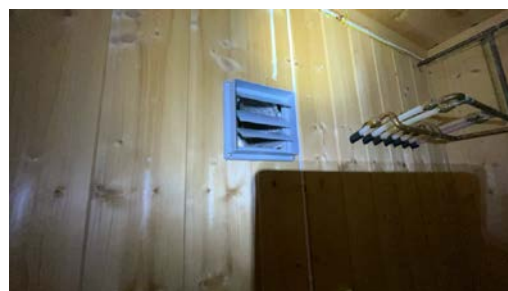
Avtrekk fra bad kommer inn i teknisk rom
