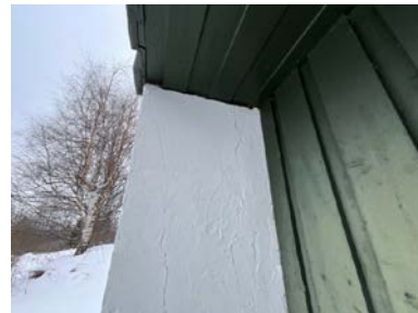
Sprekker i utv grunnmur
