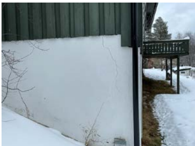
Sprekk i utv grunnmur, vest vegg
