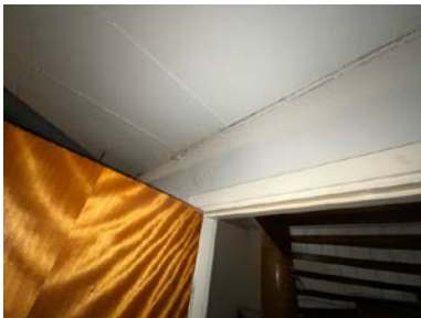
Sprekk i mur over dør mot trapperom.
