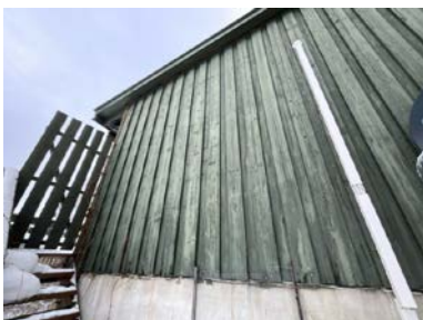
Værslitt kledning på østveggen
