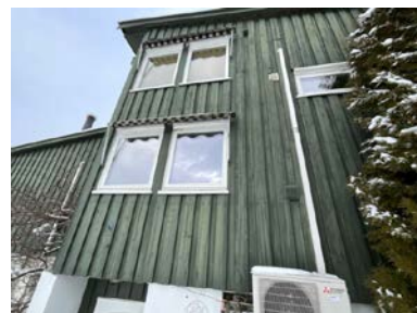
Værslitt kledning på østveggen
