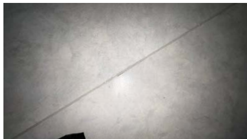
Sprekk i sveis på gulvbelegget
