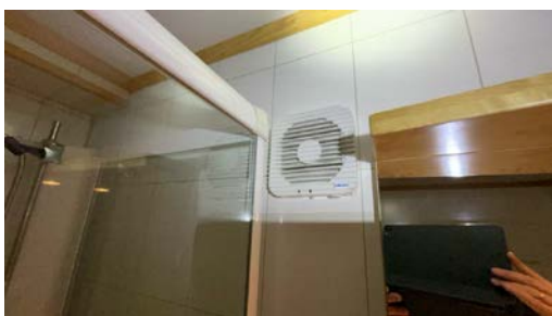
Avtrekk på bad
