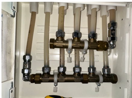
Samleskap med rørkurser og stoppekraner
