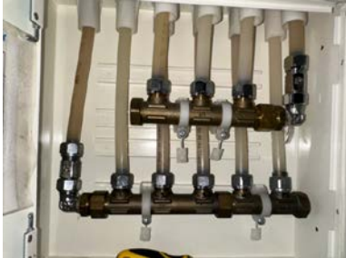
Samleskap med rørkurser og stoppekraner
