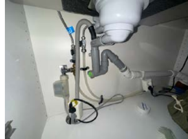
Rørropplegg i kjøkkenbenk
