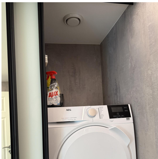
Ventil bak skyvedør på bad.
