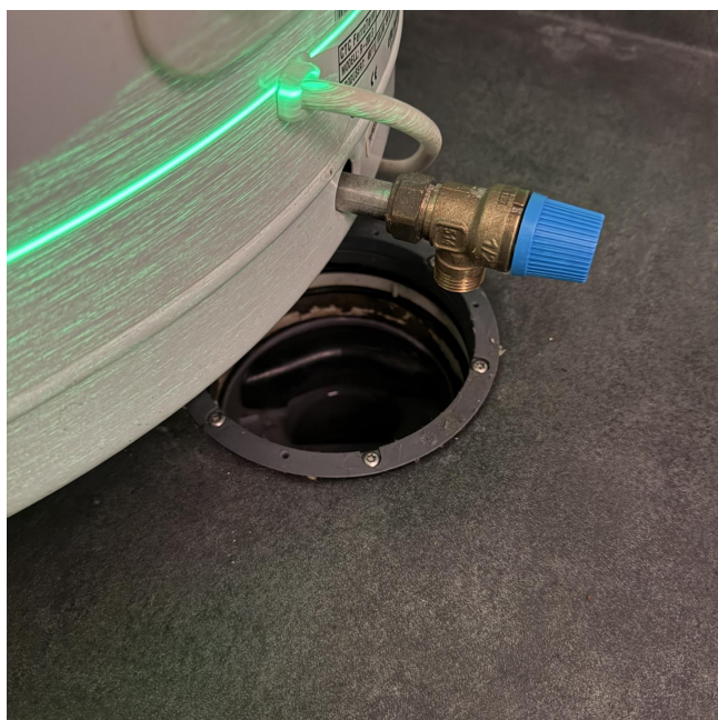
Sluk ved bereder.
