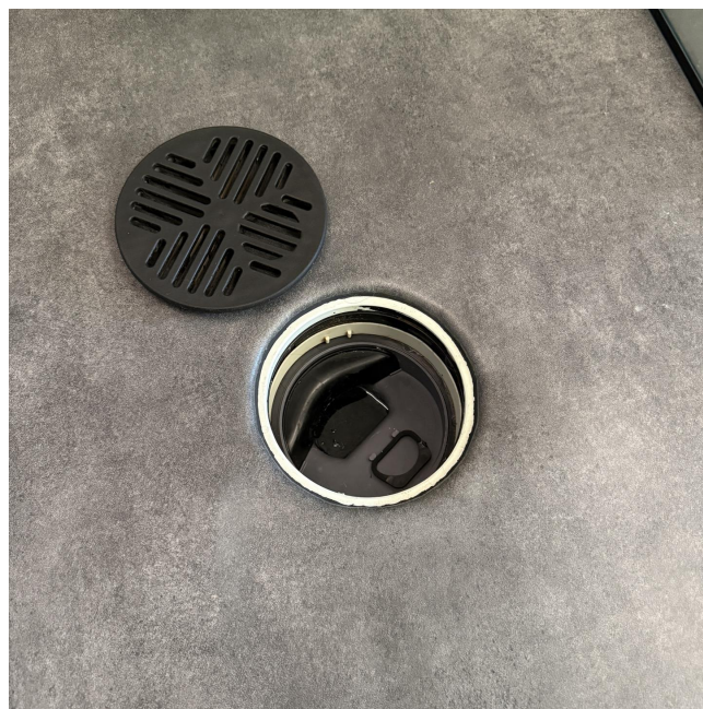
Sluk i dusjsone.
