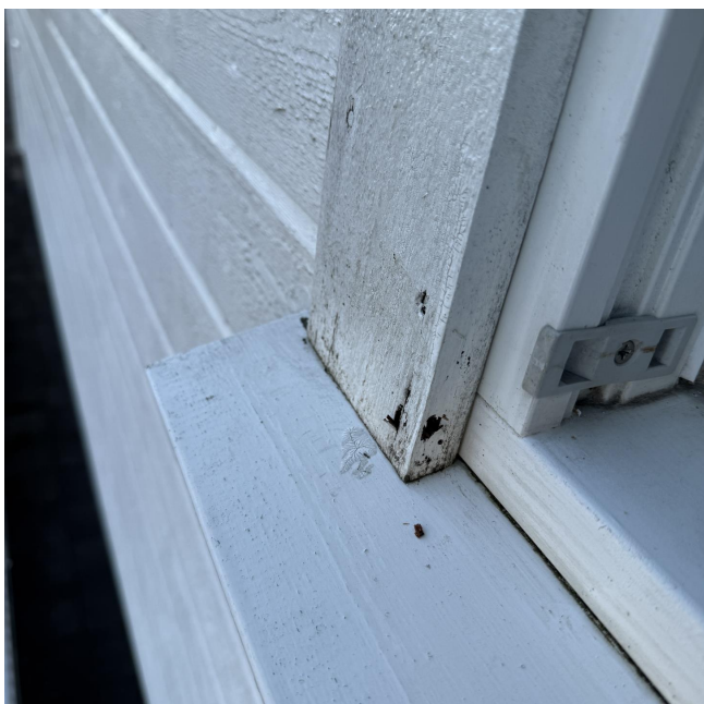
Råte i bunnen av belistningsbord utvendig.
