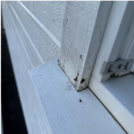
Råte i bunnen av belistningsbord utvendig.
