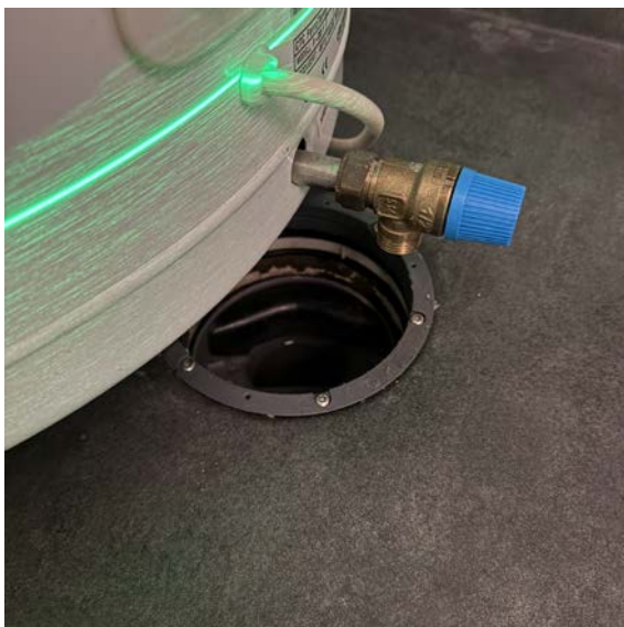
Sluk ved bereder.
