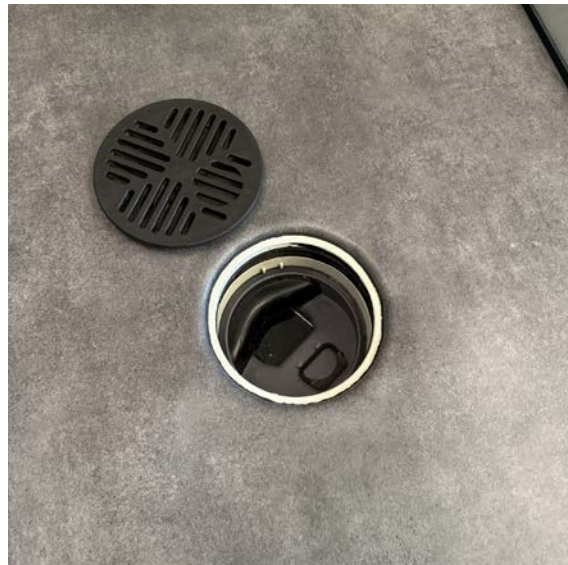
Sluk i dusjsone.
