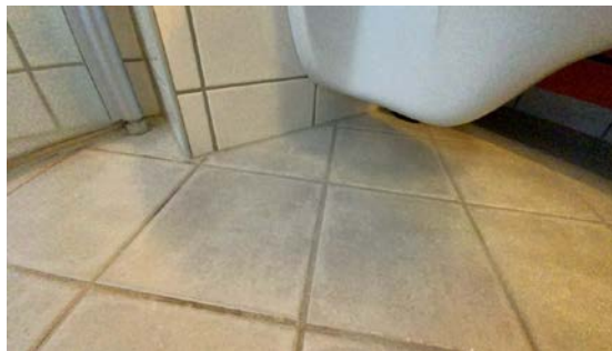
Lekkasjespalte på innebygget systerne bør opparbeides.
