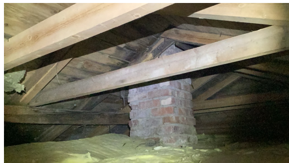
Misfarging rundt pipe.
