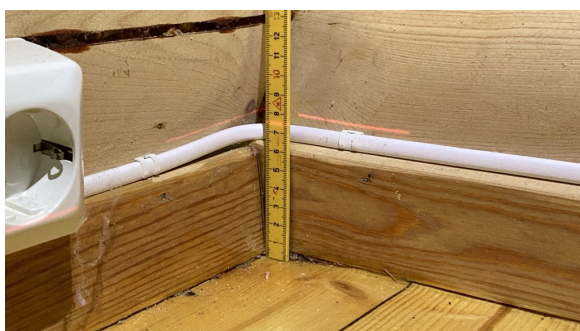
Helningsavvik på 35 mm ble målt på kjøkken.
