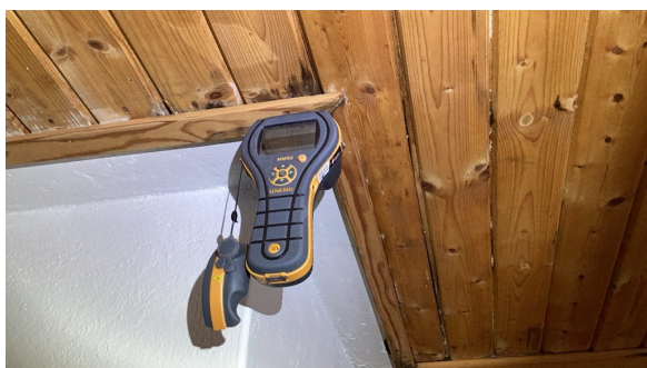
Ved enkel fuktmåling målte jeg tørre verdier.
