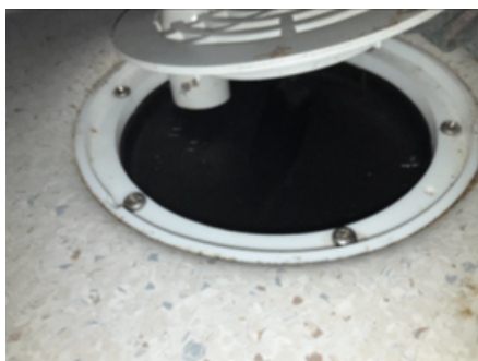
Sluk under dusjkabinett.
