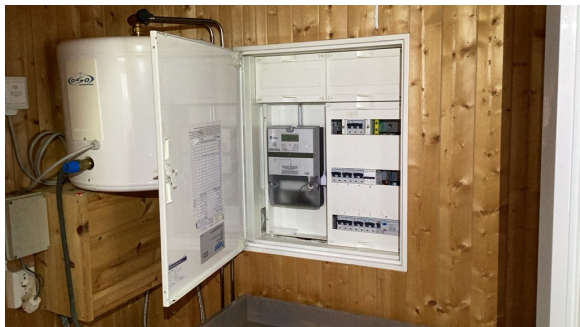
Sikringsskap på bad.
