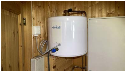
Varmtvannsbereder på bad.
