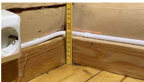
Helningsavvik på 35 mm ble målt på kjøkken.
