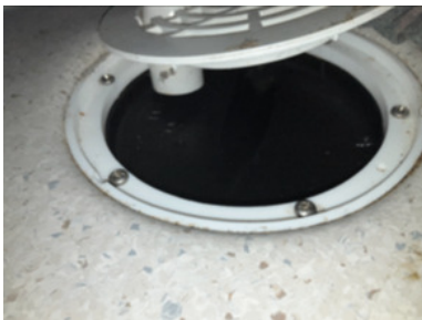
Sluk under dusjkabinett.
