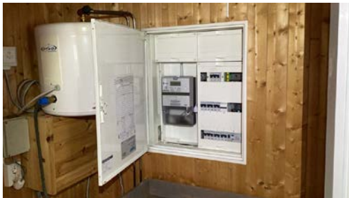
Sikringsskap på bad.
