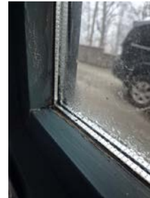
Innvendig tegn til kondensering.
