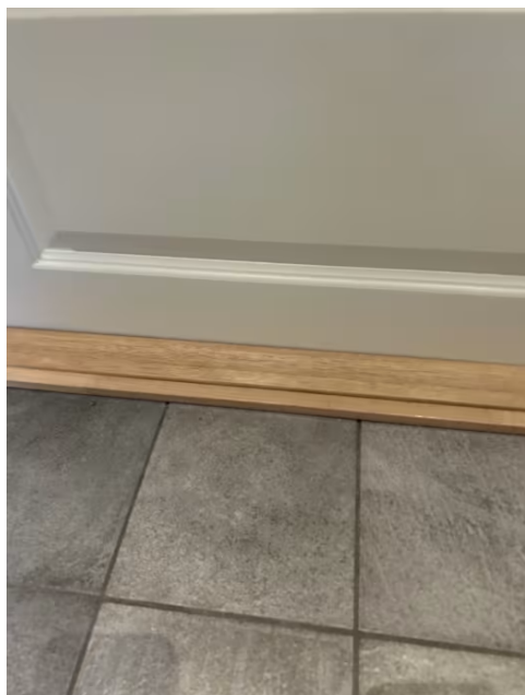
Ingen synlig tettesjikt ved dør.
