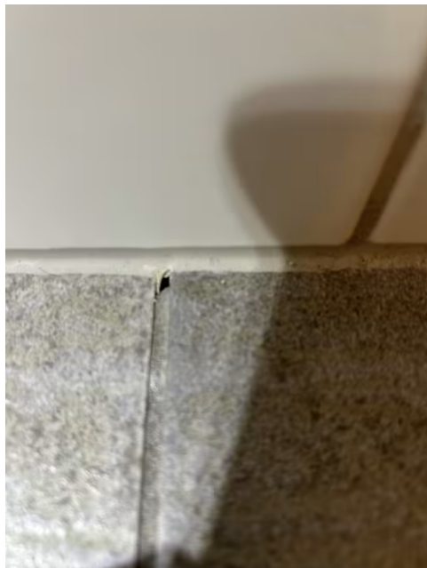
Sprekk i fuger.
