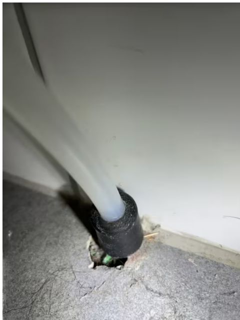
Ingen synlig membran rundt rørgjennomføring.
