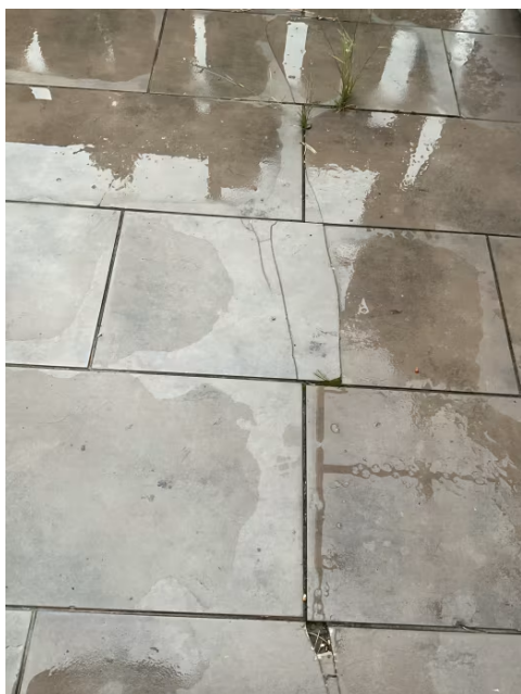
Sprekker i fliser på terrassen.
