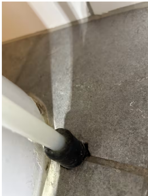
Ingen synlig membran rundt rørgjennomføring.
