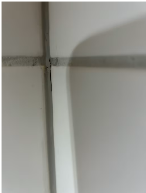
Sprekk i fuger på vegg.
