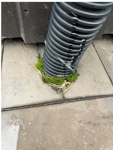
Sprekk i avløp fra takrenne.
