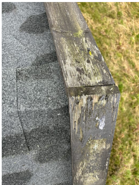
Råtne isbord over vindskie.
