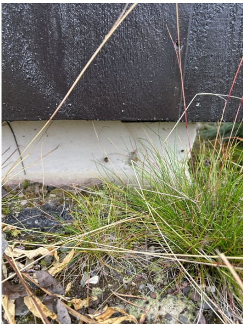
Synlig isopor på ringmur.
