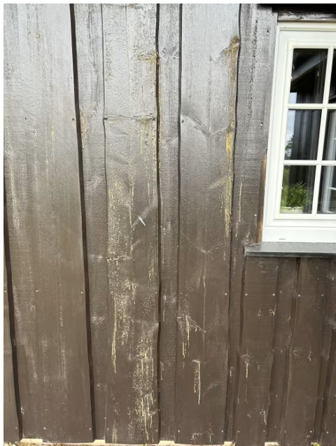
Utslag av kvae i panel.
