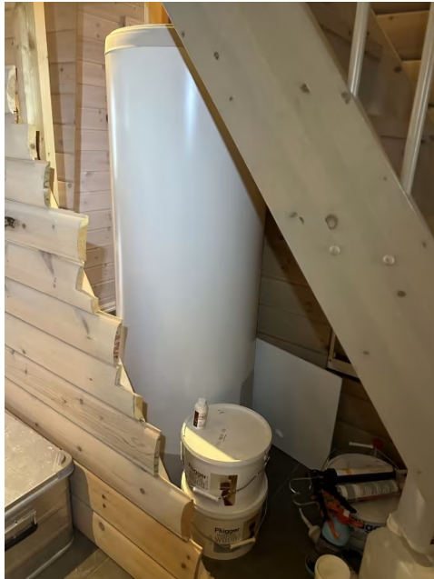
Varmtvannsbereder er plassert i rom under trapp.
