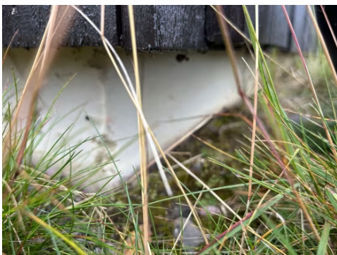
Synlig isopor på ringmur.
