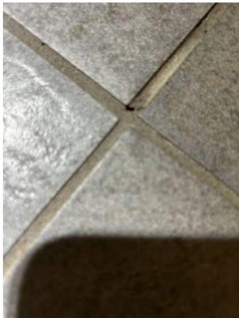
Sprekk i fuger.
