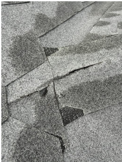
Sprekk i shingel over møne.
