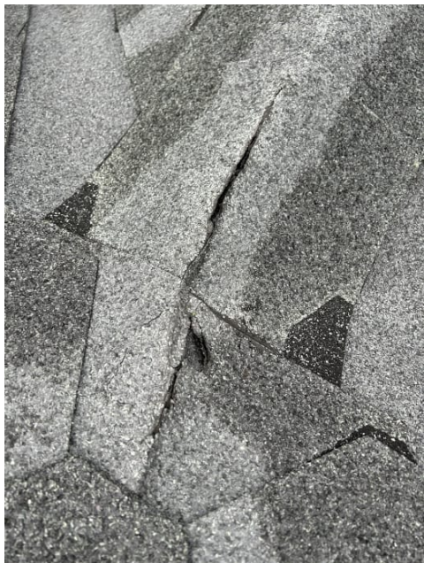
Sprekk i shingel over møne.
