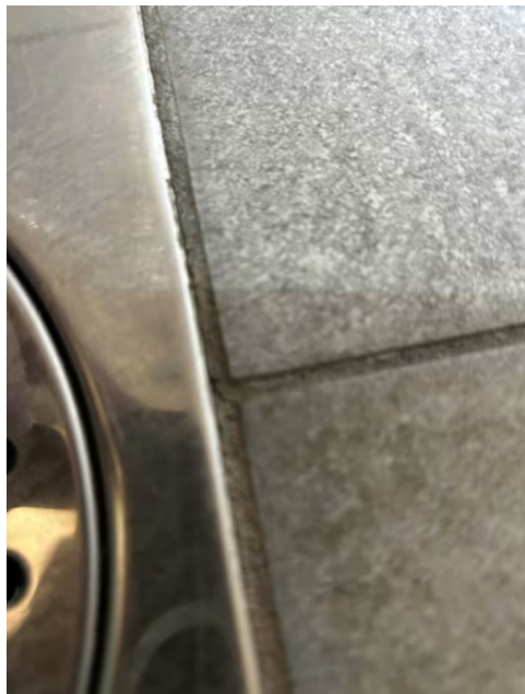
Sprekk i fuger.
