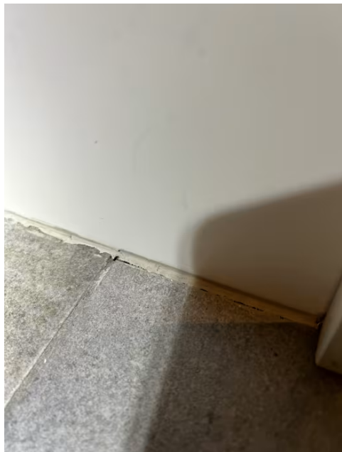
Sprekk i fuge overgang gulv vegg
