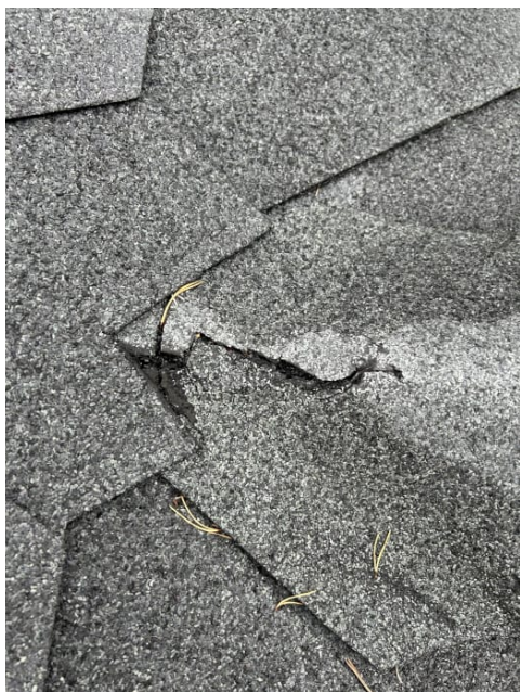
Sprekk i shingel over møne.
