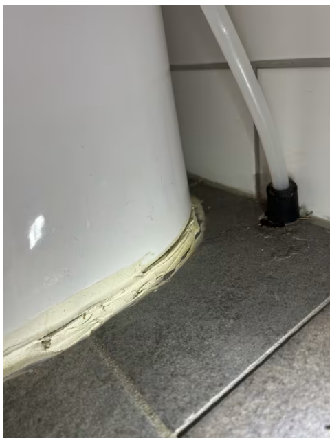
Sprekker i fug rundt wc.
