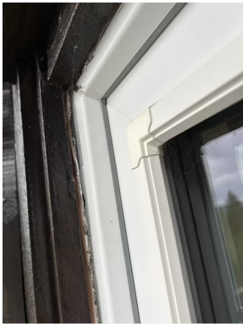
Glippe mellom panel og vindu.
