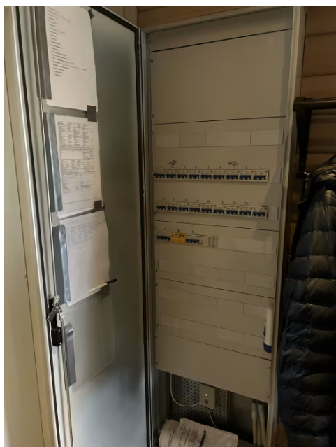
Sikringsskap plassert i gang.
