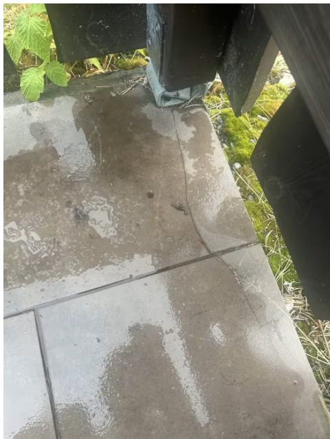
Sprekker i fliser på terrassen.
