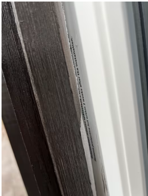
Glippe mellom panel og vindu.
