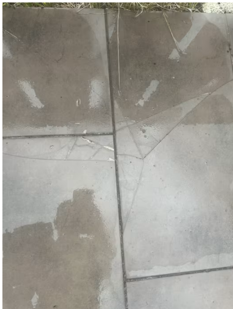
Sprekker i fliser på terrassen.
