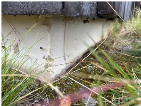
Synlig isopor på ringmur.
