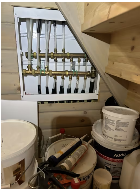
Fordelerskap til vann, plassert i rom under trapp.
