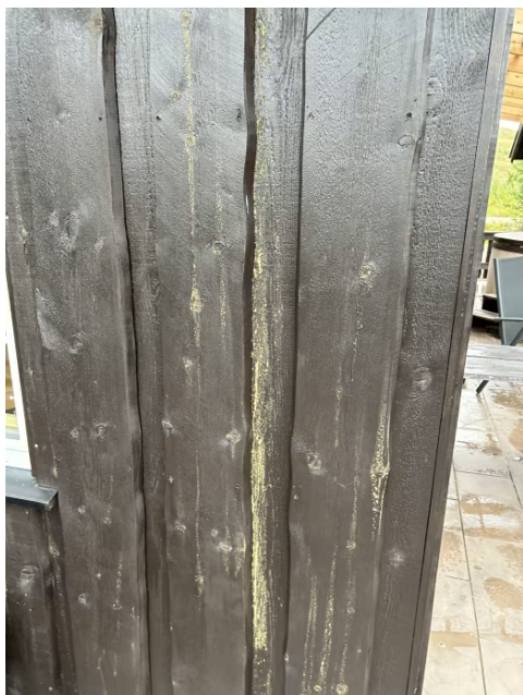
Utslag av kvae i panel.
