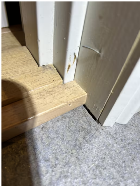
Manglende tettesjikt ved døråpning.
