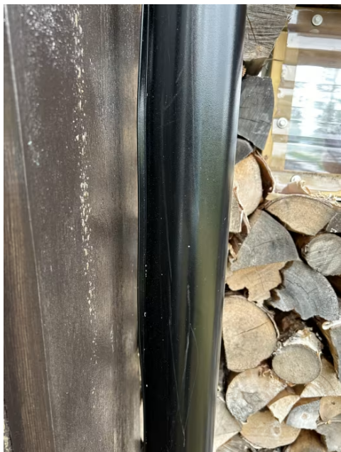
Frostspreng i nedløp.
