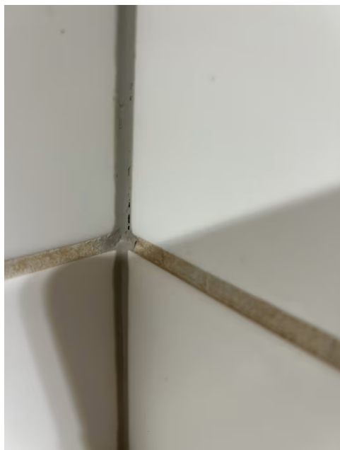
Sprekk i hjørne på vegg.
