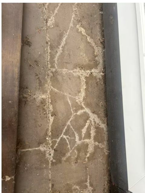
Sprekker i fliser på terrassen.
