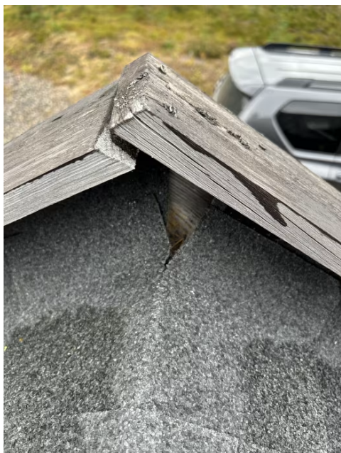
Sprekk i shingel over møne.
