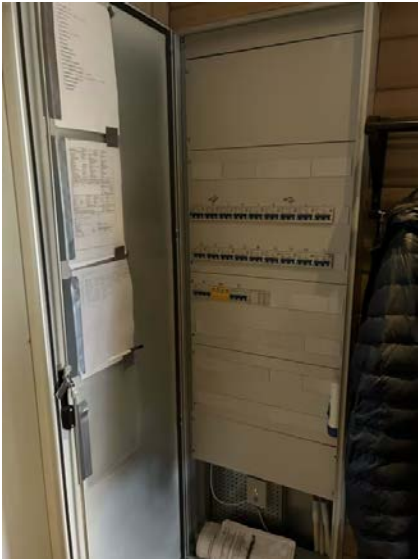
Sikringskap plassert i gang.
