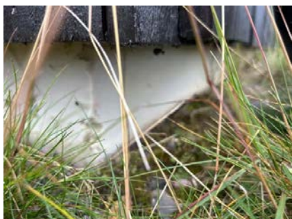
Synlig isopor på ringmur.
