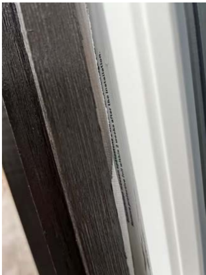
Glippe mellom panel og vindu.
