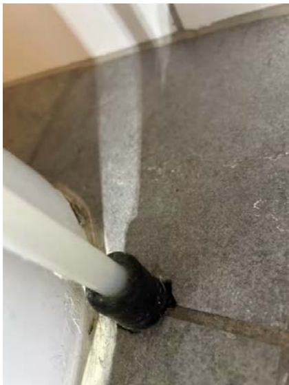
Ingen synlig membran rundt rørgjennomføring.
