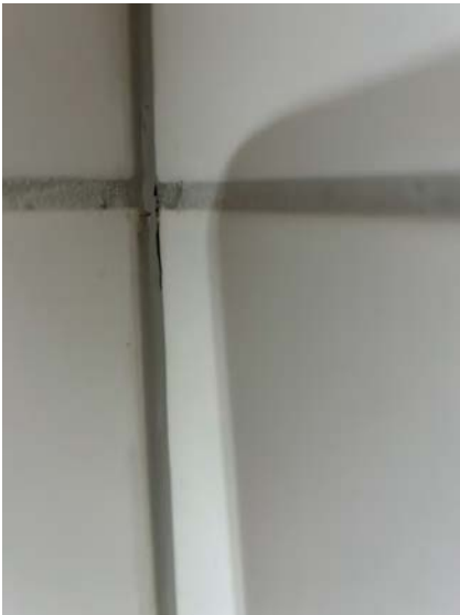
Sprekk i fuger på vegg.
