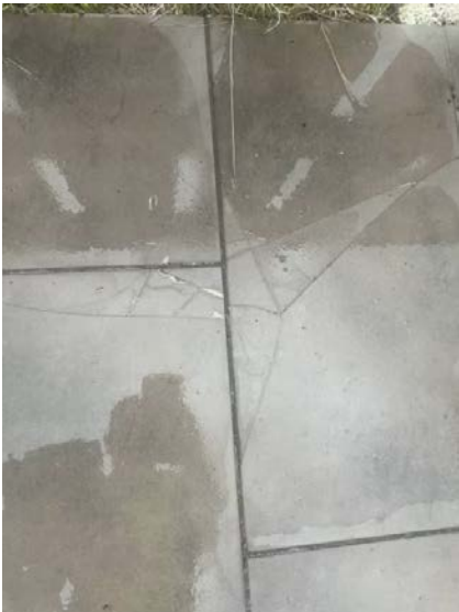
Sprekker i fliser på terrassen.
