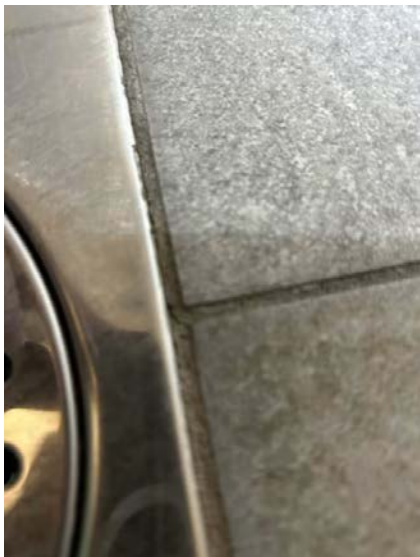
Sprekk i fuger.
