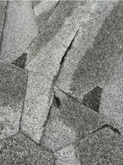
Sprekk i shingel over møne.
