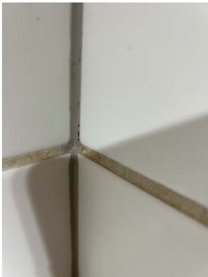
Sprekk i hjørne på vegg.
