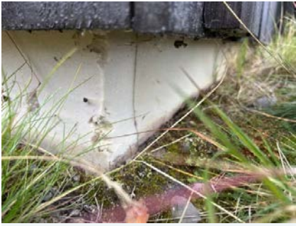
Synlig isopor på ringmur.
