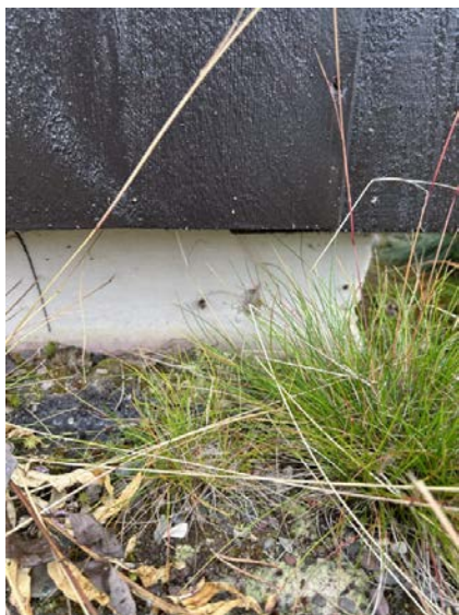
Synlig isopor på ringmur.
