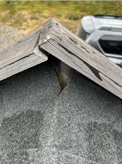
Sprekk i shingel over møne.
