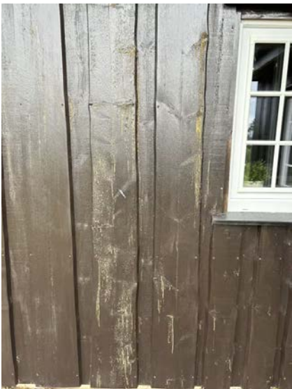
Utslag av kvae i panel.
