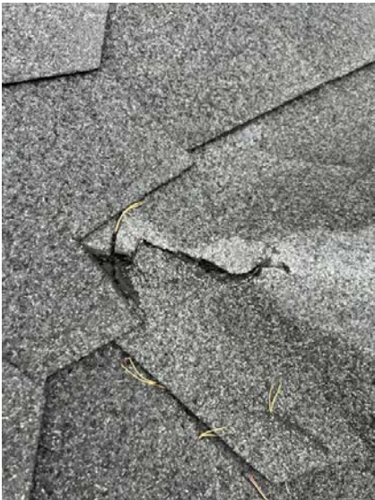
Sprekk i shingel over møne.
