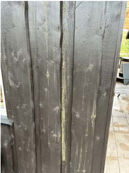
Utslag av kvae i panel.
