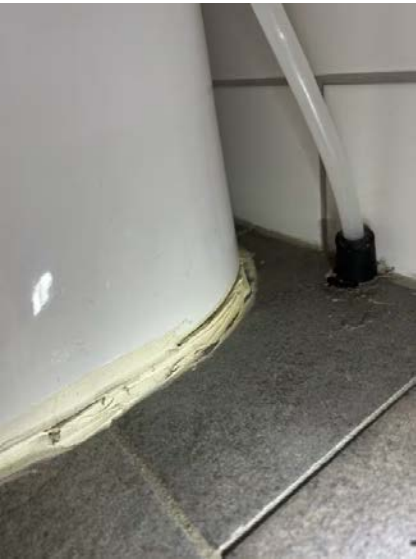
Sprekker i fug rundt wc.
