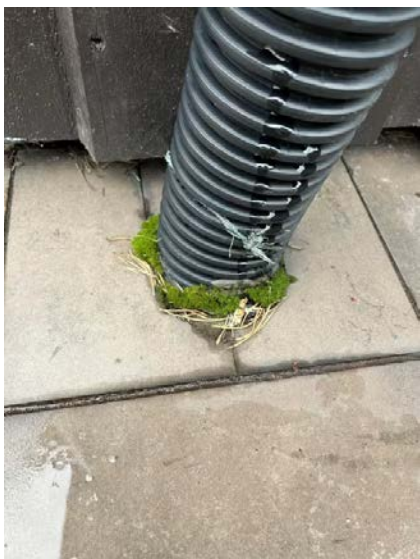
Sprekk i avløp fra takrenne.
