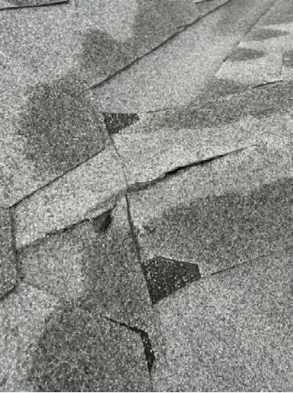
Sprekk i shingel over møne.
