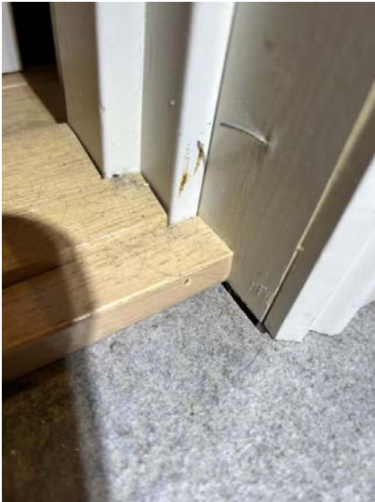
Manglende tettesjikt ved døråpning.
