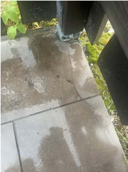
Sprekker i fliser på terrassen.
