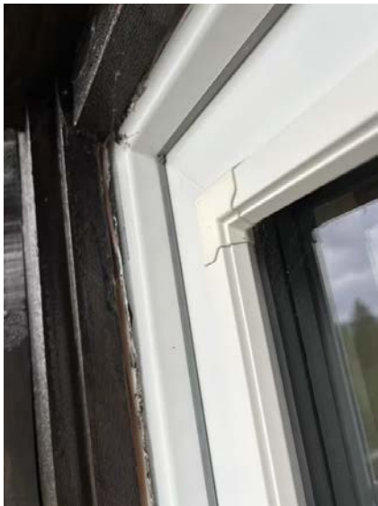
Glippe mellom panel og vindu.
