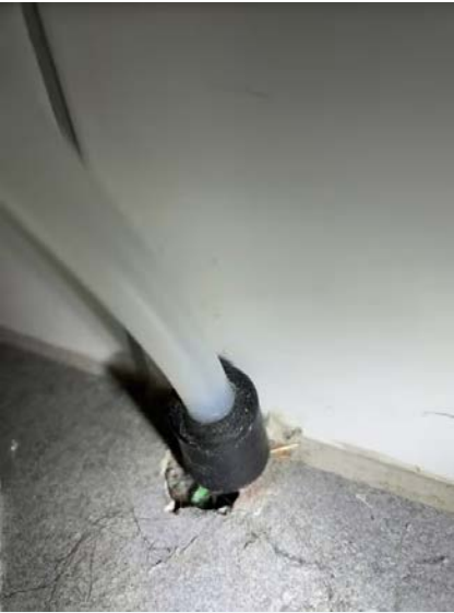
Ingen synlig membran rundt rørgjennomføring.
