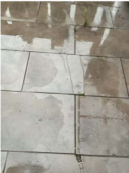
Sprekker i fliser på terrassen.
