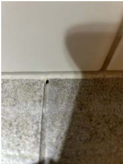
Sprekk i fuger.
