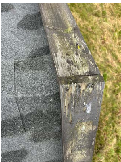
Råtne isbord over vindskie.
