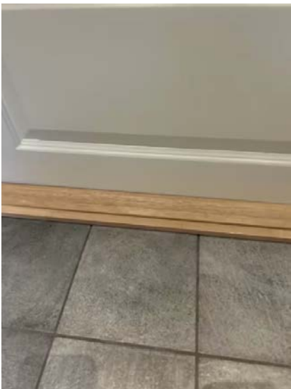
Ingen synlig tettesjikt ved dør.
