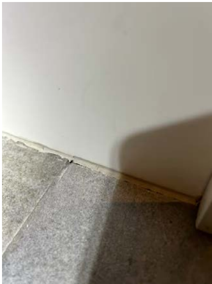
Sprekk i fuge overgang gulv vegg
