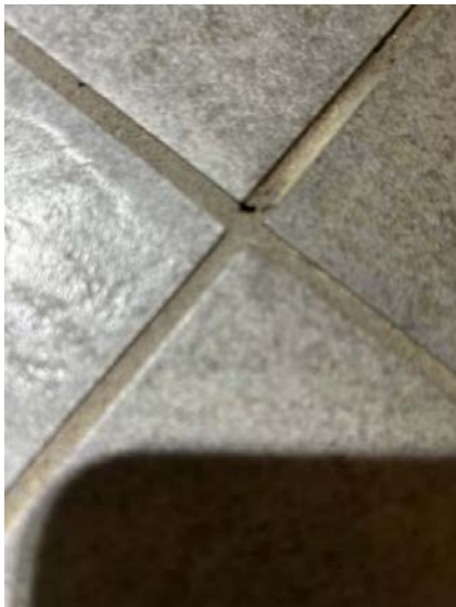
Sprekk i fuger.
