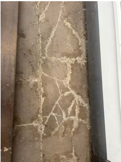
Sprekker i fliser på terrassen.
