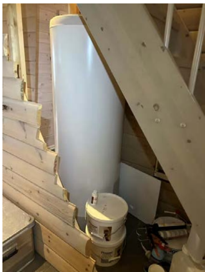
Varmtvannsbereder er plassert i rom under trapp.
