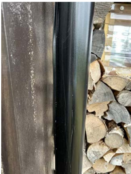
Frostspreg i nedløp.
