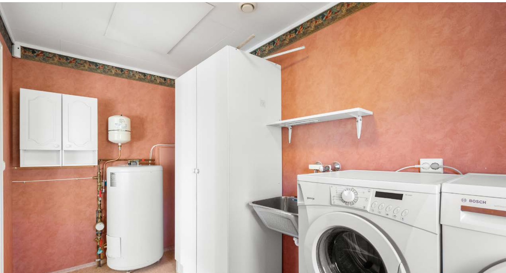
Vaskerommet er utstyrt med utslagsvask, varmtvannsbereder og vannuttak for vaskemaskin. Tilgang til loft fra vaskerommet.
