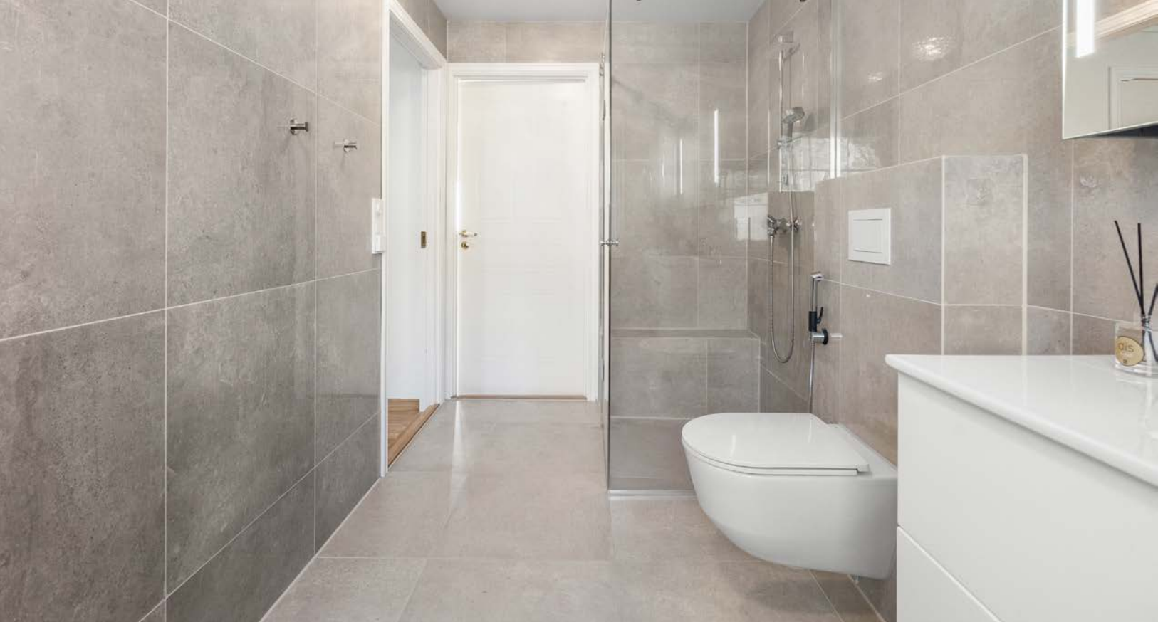
Baderomsinnredning med skuffer for god oppbevaringsplass for håndkle og diverse baderomsartikler.
