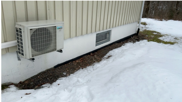
Manglende fuktsikring til venstre, og fuktsikring fra 2011 til høyre
