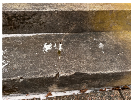
Betongtrapp med noen sprekker og setninger
