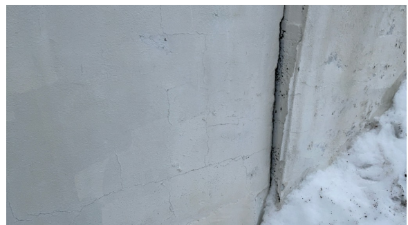
Riss i puss på hjørne mot forstøtningsmur
