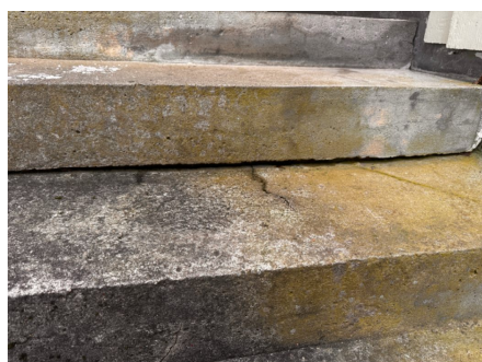
Betongtrapp med noen sprekker og setninger
