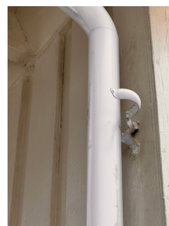
Manglende innfesting av nedløp
