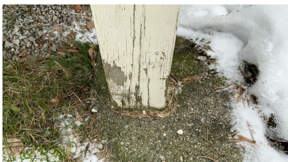
Søyle direkte på betong
