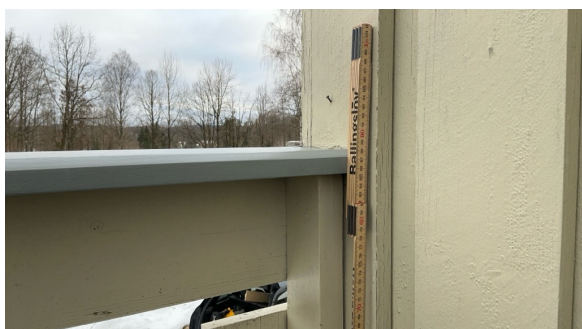
Rekkverkshøyde på balkong
