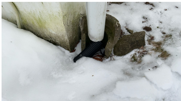
Ikke tilfredstillende bortledning av vann
