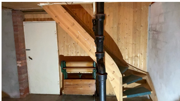
Manglende rekkverk og håndløper på innvendig trapp
