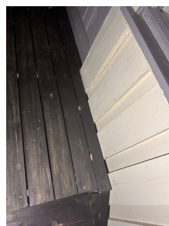
Manglende beslag i overgang terrasse og yttervegg
