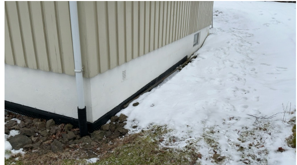
Manglende fuktsikring oppe i hjørne til høyre, og fuktsikring fra 2011 til venstre
