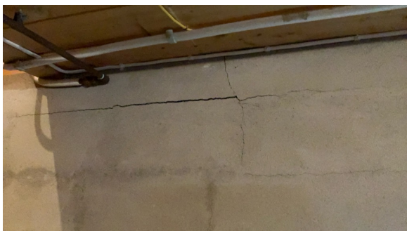
Sprekk i mur ved trapp i kjeller
