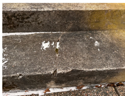
Betongtrapp med noen sprekker og setninger
