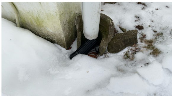
Ikke tilfredstillende bortledning av vann
