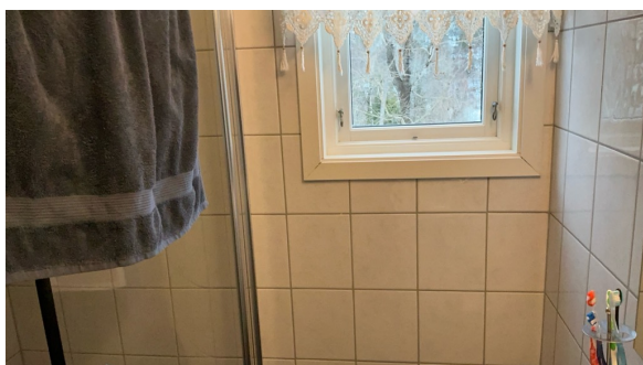
Vindu i våtzone
