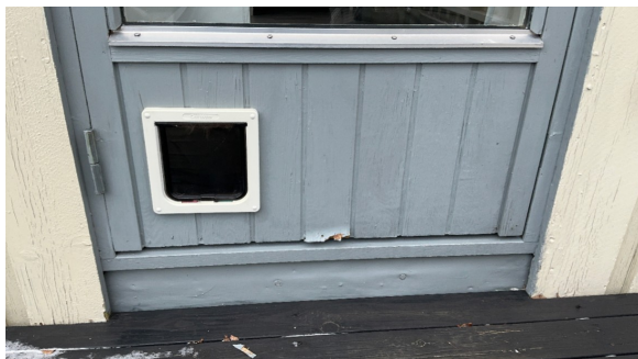
Oppsprekket og tendens til råte
