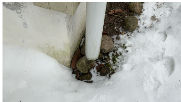
Mangler bortledning av vann
