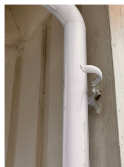
Manglende innfesting av nedløp
