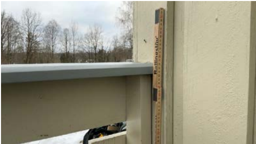
Rekkverkshøyde på balkong
