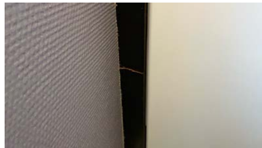
Knekk i foring mellom oppvaskmaskin og yttervegg
