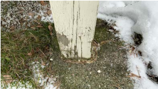
Søyle direkte på betong
