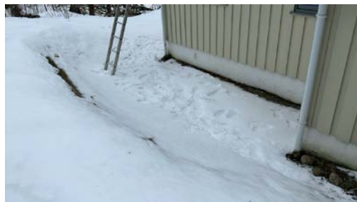
Dårlig fall eller flatt terreng inn mot grunnmur
