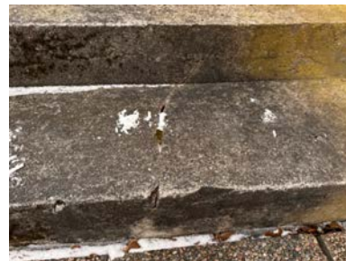
Betongtrapp med noen sprekker og setninger
