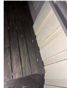
Manglende beslag i overgang terrasse og yttervegg
