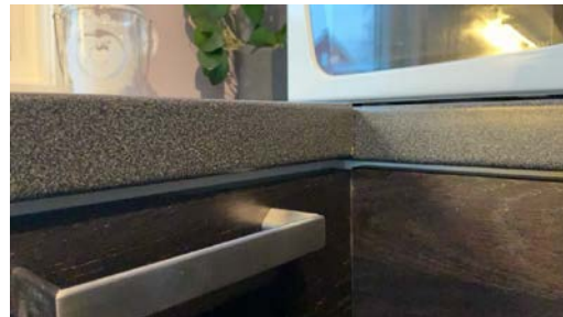
Høydeforskjell på benkeplaten
