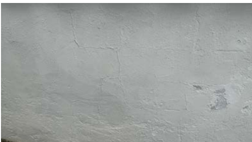
Riss i puss
