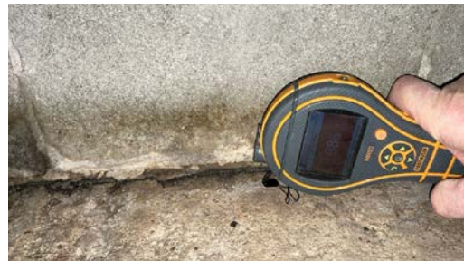
Fuktutslag på vegg
