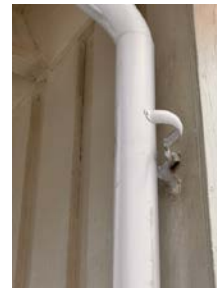
Manglende innfesting av nedløp
