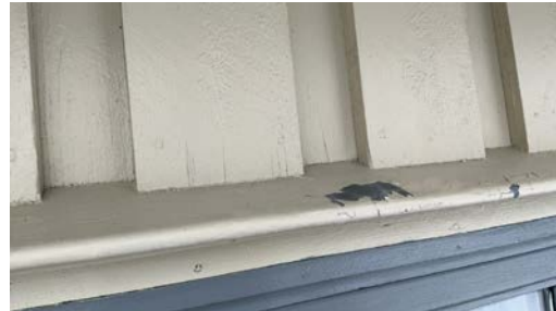
Det er registrert ingen klaring mellom beslag og trevirke.
