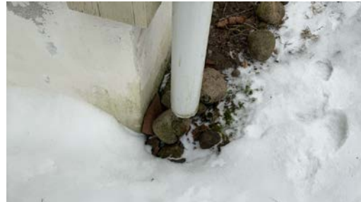
Mangler bortledning av vann
