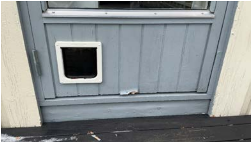
Oppsprekket og tendens til råte
