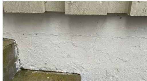
Riss i puss
