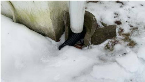
Ikke tilfredstillende bortledning av vann
