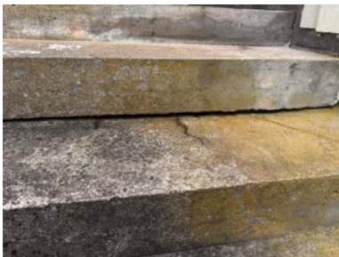
Betongtrapp med noen sprekker og setninger
