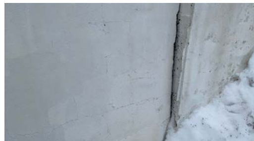
Riss i puss på hjørne mot forstøtningsmur
