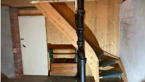
Manglende rekkverk og håndløper på innvendig trapp
