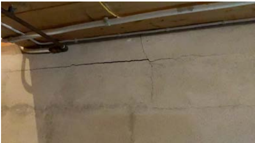
Sprekk i mur ved trapp i kjeller
