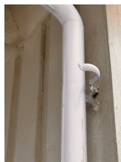
Manglende innfesting av nedløp
