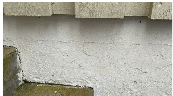
Riss i puss
