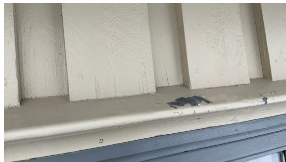
Det er registrert ingen klaring mellom beslag og trevirke.
