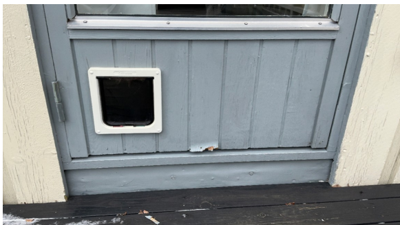
Oppsprekket og tendens til råte
