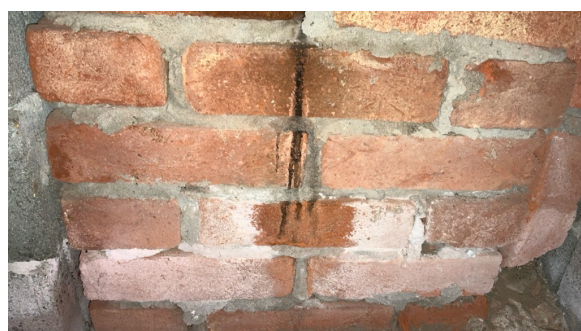
Renning fra sotluke
