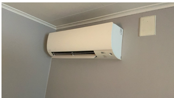
Luft til luft varmepumpe
