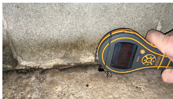
Fuktutslag på vegg
