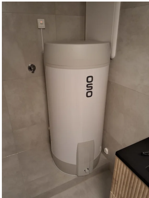
Varmtvannsbereder er plassert på bad i kjeller.
