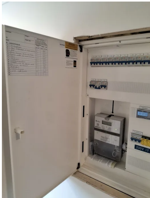
Sikringsskap med automatsikringer er plassert i trappegang.
