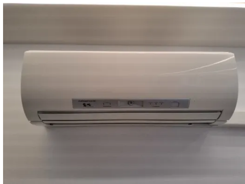
Varmepumpe i kjellerstue.
