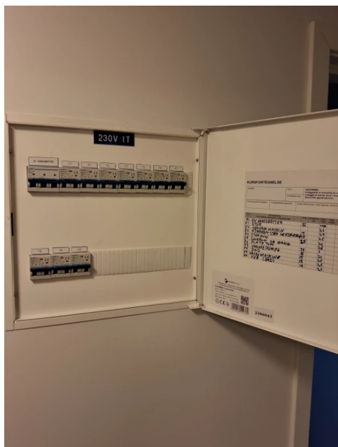
Underskap er plassert i gang i kjeller.
