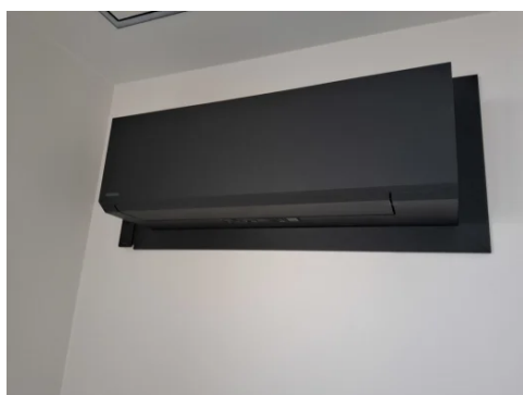
Varmepumpe i stue.
