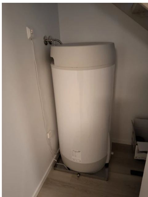
Varmtvannsbereder er plassert under trapp i kjelleretasje.
