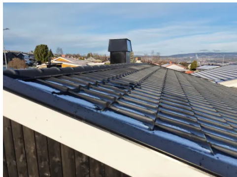
Det registreres skjevheter i konstruksjonen.
