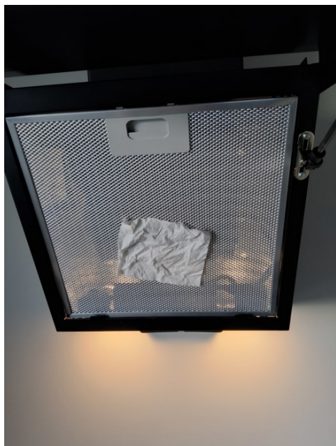
Avtrekkseffekten er testet med papir.
