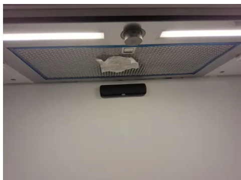
Avtrekkseffekten er testet med papir.
