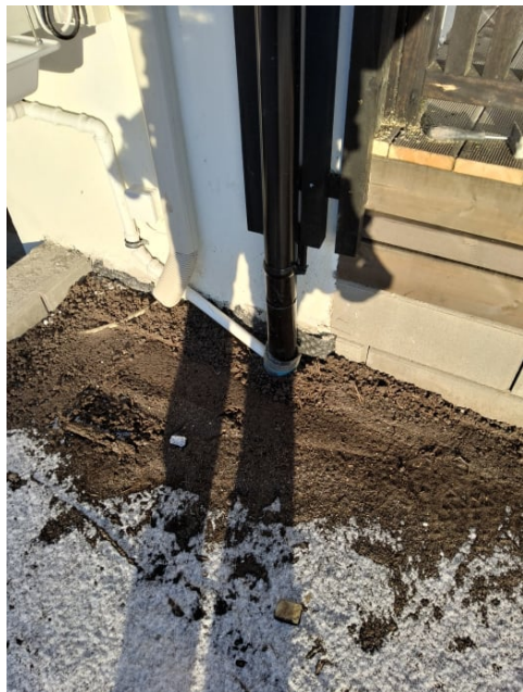
Taknedløp er ledet til drensrør.
