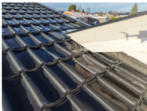
Det registreres bulker i takplater.
