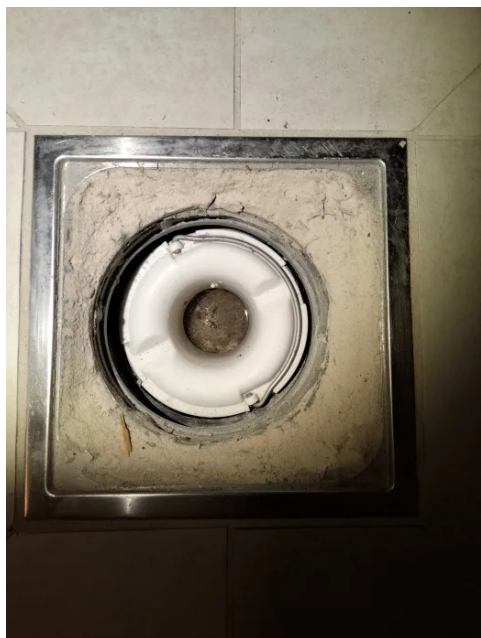
Klemring til sluk er dekket av flislim.
