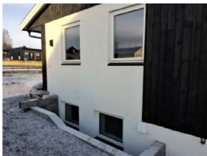
Boligen har vinduer med tre-lags glass.
