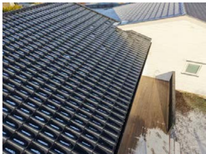
Det er ikke etablert snøfanger på takflate mot terrasse.
