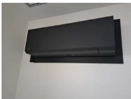
Varmepumpe i stue.
