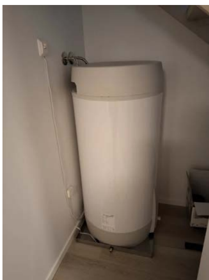
Varmtvannsbereder er plassert under trapp i kjelleretasje.
