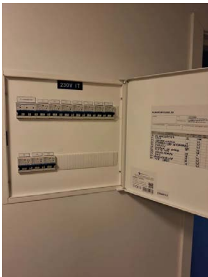
Underskap er plassert i gang i kjeller.
