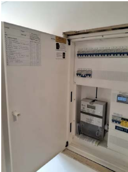
Sikringsskap med automatsikringer er plassert i trappegang.
