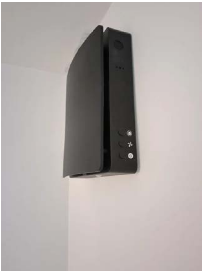
Boligen er ventilert med romventilatorer.
