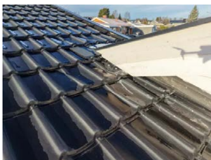
Det registreres bulker i takplater.
