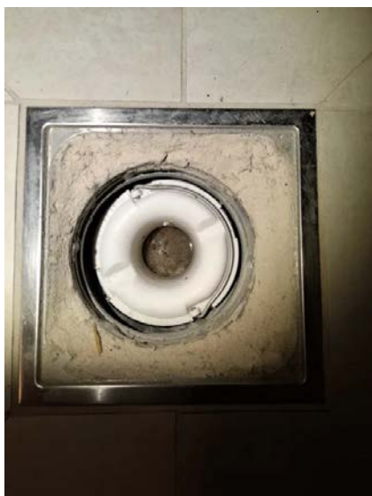
Klemring til sluk er dekket av flislim.
