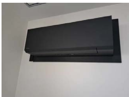
Varmepumpe i stue.
