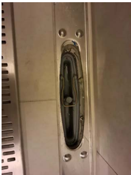
Ingen registrerte avvik i overgang sluk/membran.
