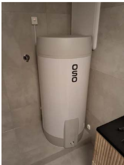
Varmtvannsbereder er plassert på bad i kjeller.
