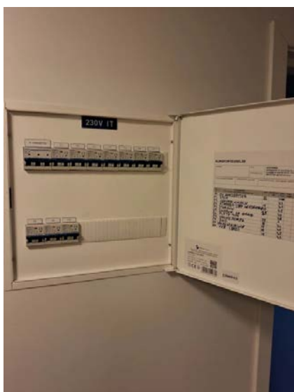
Underskap er plassert i gang i kjeller.
