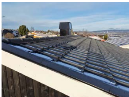
Det registreres skjevheter i konstruksjonen.
