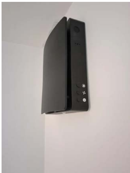
Boligen er ventilert med romventilatorer.
