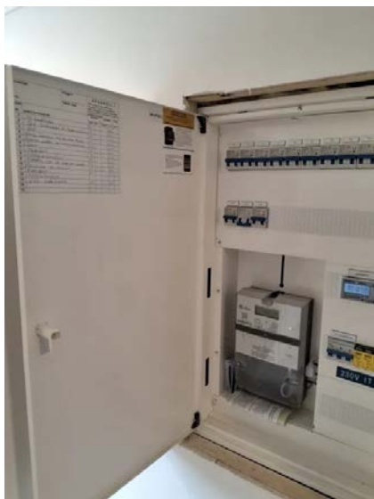
Sikringsskap med automatsikringer er plassert i trappegang.
