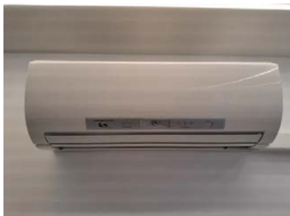
Varmepumpe i kjellerstue.
