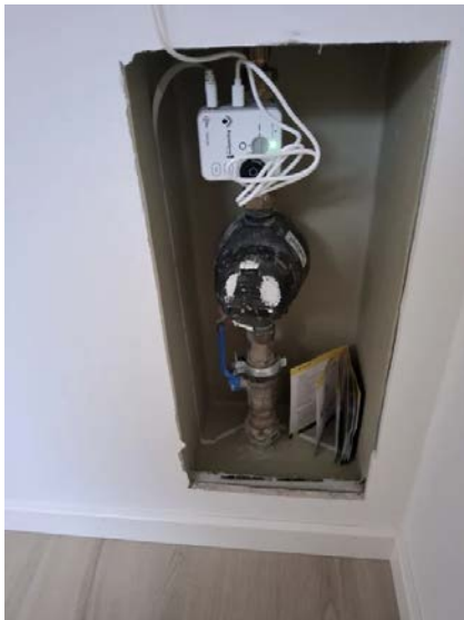
Hovedstoppekran og automatisk vannstoppevetil er plassert i kasse på soverom i kjelleretasje.
