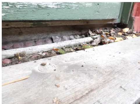
Uegnet tekkemateriale og utett utførelse mot vegg kan ha ført til skjulte skader.
