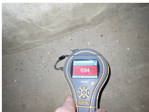
Høyt fuktnivå mot grunn.
