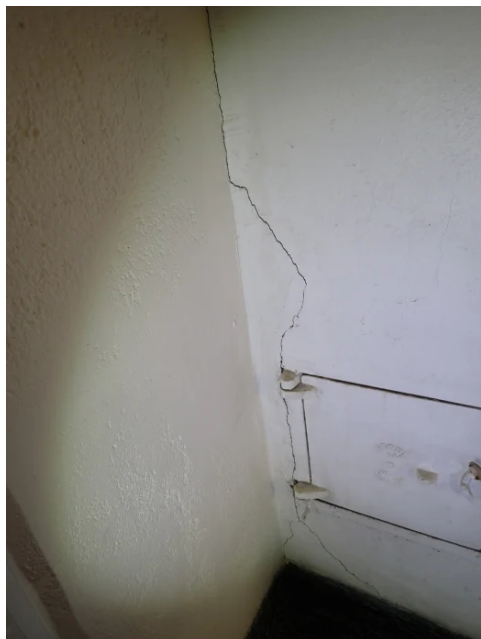
Sprekker i pipemur.
