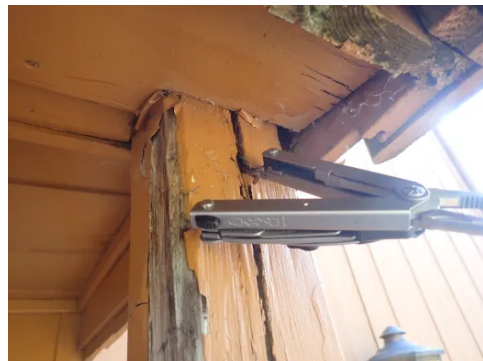
Råteskader i hovedbæring.
