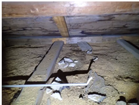
Fuktskjolder i taktro / tynt isolasjonslag.
