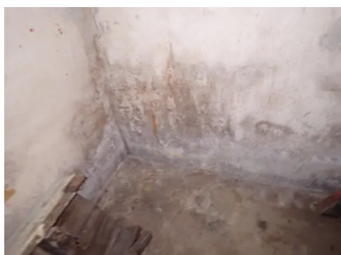
Saltutslag i grunnmur i kjeller.
