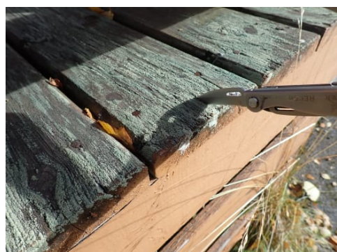
Råte i gulvbord.
