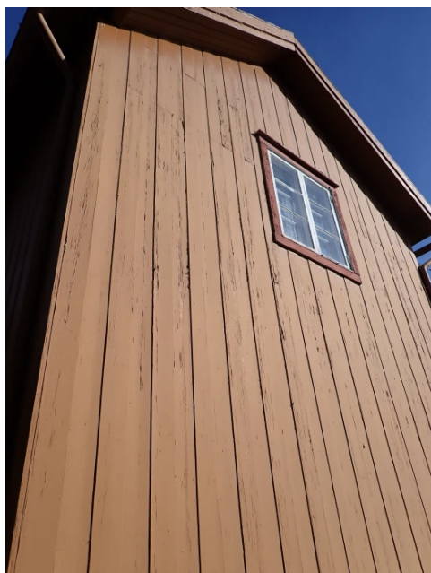
Værslitasje/malingsavskalling i kledning.
