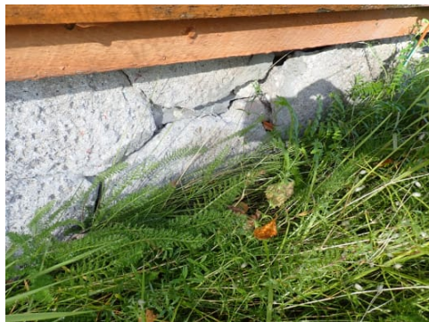
Sprekkdannelse i grunnmur.
