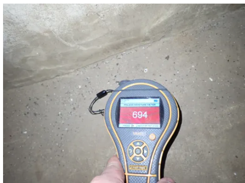
Fukt i kjeller.
