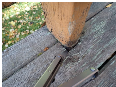
Råte i rekkverksstolpe.
