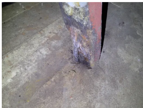
Råteskade i kjellertrapp.
