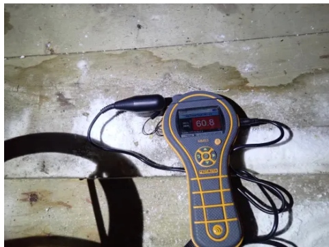
Høyt fuktnivå i gulvkonstruksjon i kott under trapp.
