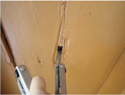
Råteskader oppunder balkonggulv.
