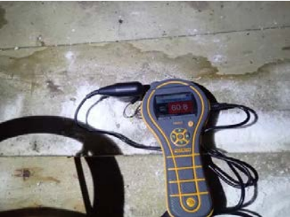
Det er påvist et høyt fuktnivå i treverk i gulvet i kottet.
