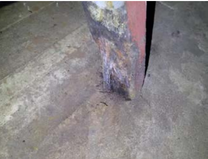
Råteskade i kjellertrapp.
