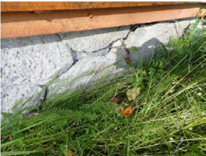
Sprekkdannelse i grunnmur.
