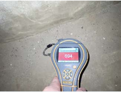
Høyt fuktnivå mot grunn.
