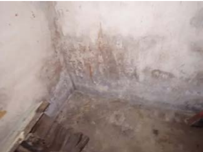
Saltutslag i grunnmur i kjeller.
