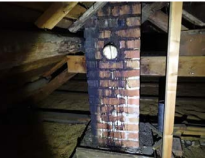
Beksot på pipemur.
