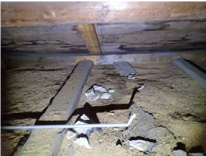
Fuktskjolder i taktro / tynt isolasjonslag.
