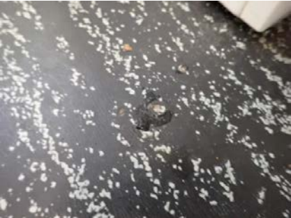
Punktering i gulvbelegg.
