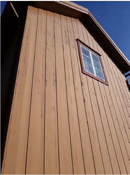
Værslitasje/malingsavskalling i kledning.
