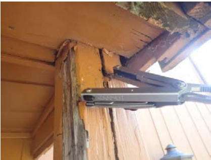
Råteskader i hovedbæring.
