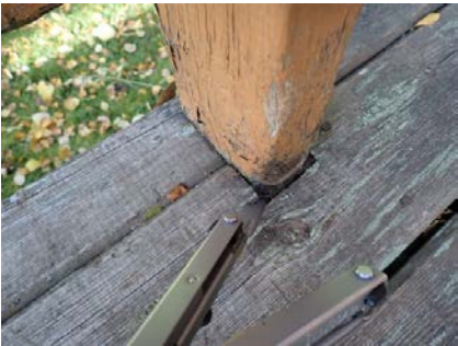
Råte i rekkverksstolpe.
