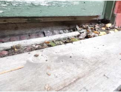
Uegnet tekkemateriale og utett utførelse mot vegg kan ha ført til skjulte skader.
