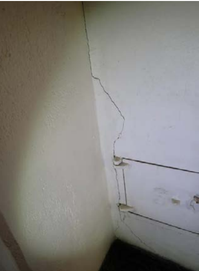
Sprekker i pipemur.
