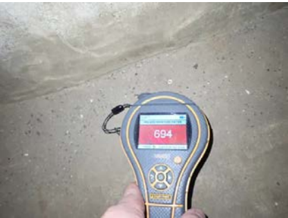
Fukt i kjeller.
