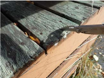
Råte i gulvbord.
