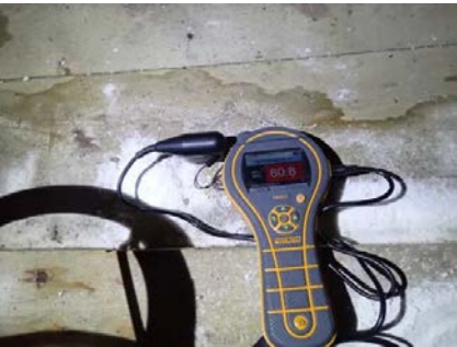
Høyt fuktnivå i gulvkonstruksjon i kott under trapp.
