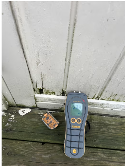
Fuktskade/råte i balkong dør.
