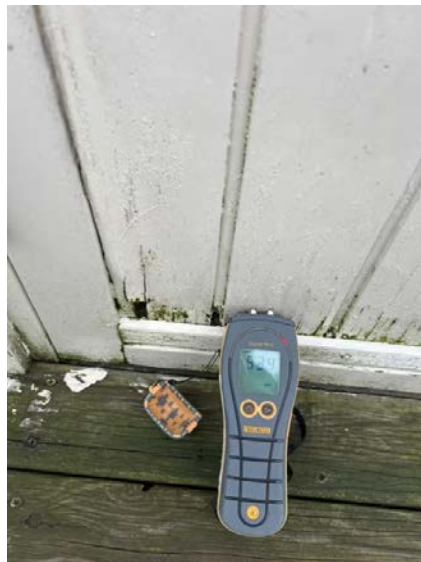
Fuktskade/råte i balkong dør.
