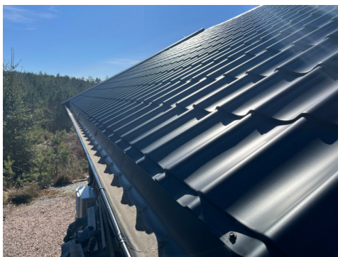
Manglende snøfangere på deler av tak.
