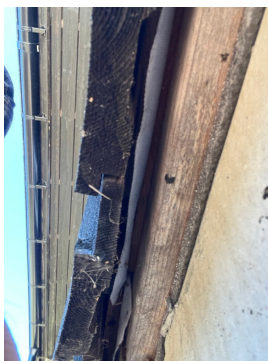
Bilde av underkant kledning med begrenset lufting.
