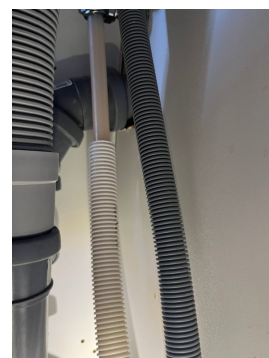
Varerør i benkeskap er ikke tettet.
