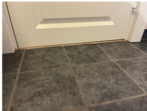
Det bør installeres luftespalte under dør.
