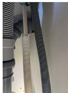
Varerør i benkeskap er ikke tettet.
