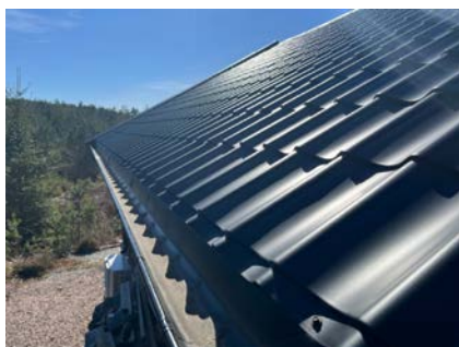
Manglende snøfangere på deler av tak.
