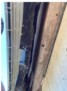
Bilde av underkant kledning med begrenset lufting.
