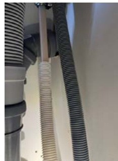
Varerør i benkeskap er ikke tettet.
