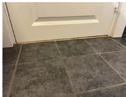
Det bør installeres luftspalte under dør.
