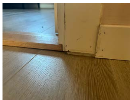
Benyttet fugemasse i nedkant av for kort dørlist er ikke fagmessig utførelse.
