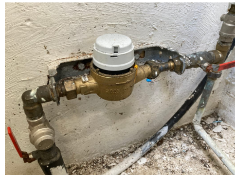
Vannmåler i utvendig kumm
