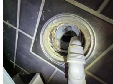
Sluk under vaskemaskin.
