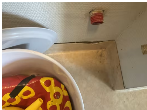
Belegg har begynt å slippe i oppbrett på vegg.
