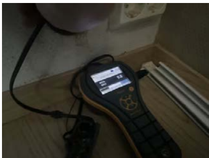
Hulltaking fra tilstøtenderom, målingen er utført i våtsonen bak dusjsonen. Målingen viser 9.8%, dette er en godkjent verdi.
