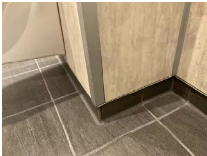
Våtromsplate på kasse til innebygd sisterner, er ikke festet tilstrekkelig.
