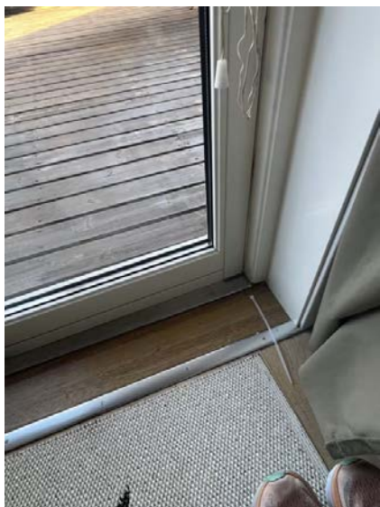
Terrassedør tar i karm.
