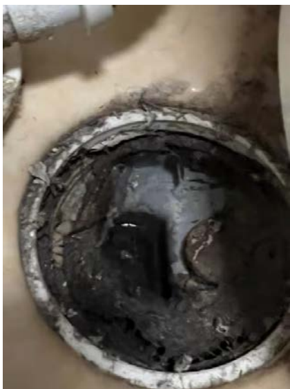
Plastsluk med synlig klemring, belegg er tettesjikt. Adkomst til sluk er begrenset.
