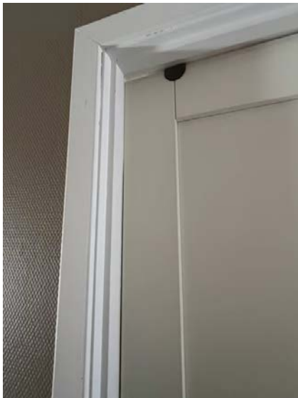
Dør til hovedsoverom tar i karm.
