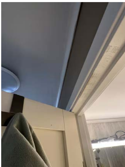
Slitasjeskader i karm, skyldes henger på dørblad.
