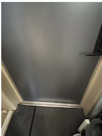
Ytterdør tar i karm
