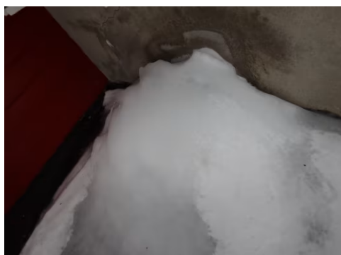
Oppsamling av is utvendig
